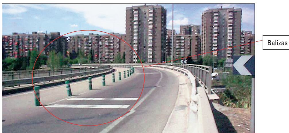
FIGURA 145. SEÑALIZACIÓN MEDIANTE BALIZAS.
