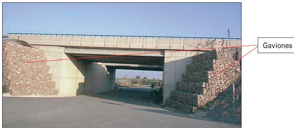
FIGURA 151. PROTECCIÓN DEL TERRAPLÉN MEDIANTE GAVIONES.
