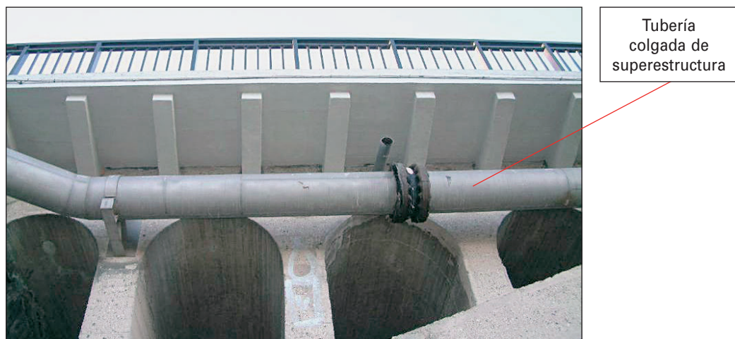
FIGURA 190. SERVICIOS ADICIONALES: TUBERÍAS DE SERVICIOS.
