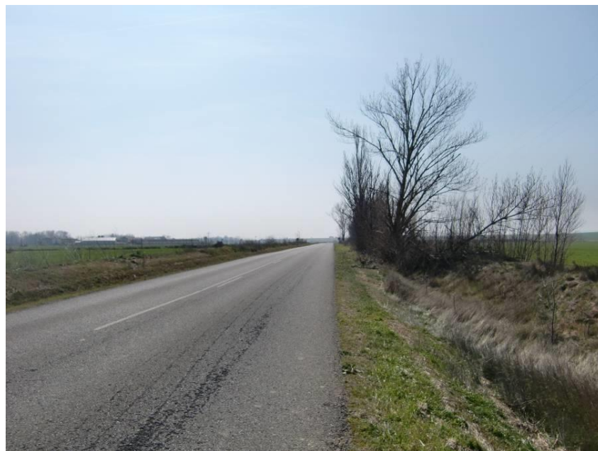
VISTA DE LA CARRETERA A-212. A PESAR DEL TRAZADO RECTO EN PLANTA SE APRECIAN DEFICIENCIAS EN SU VISIBILIDAD QUE RECOMIENDA SU REPOSICIÓN MEDIANTE UN PASO SUPERIOR.
