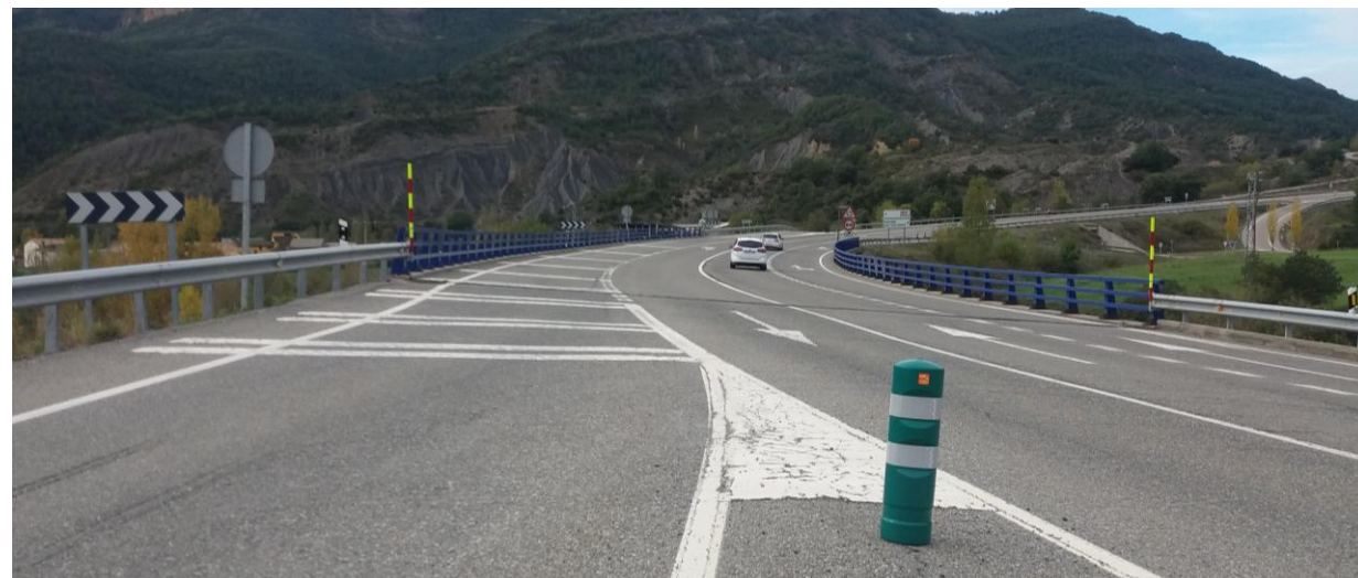
Figura 2.- Estado actual de las BTA en el carril de trenzado previo al ramal Aínsa-Graus
