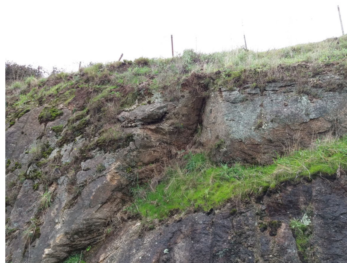
Fotografía 15. Cuñas desprendida en la cabecera del talud
