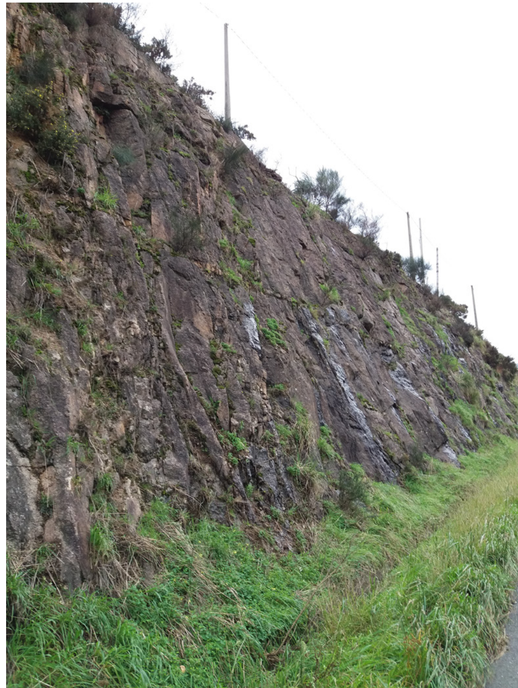
Fotografía 12. Goteos de agua en el talud
