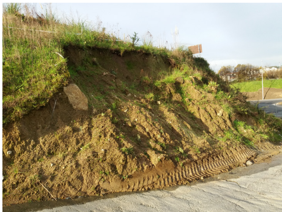
Fotografía 4. Vertidos antrópicos procedentes de excavaciones próximas. A la izquierda del trazado hacia el PK.10+700.
