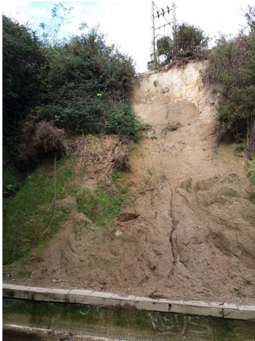
Fotografía 7. Granodioritas alteradas en grado VI, en el talud derecho de la trinchera del paso inferior del ferrocarril.
