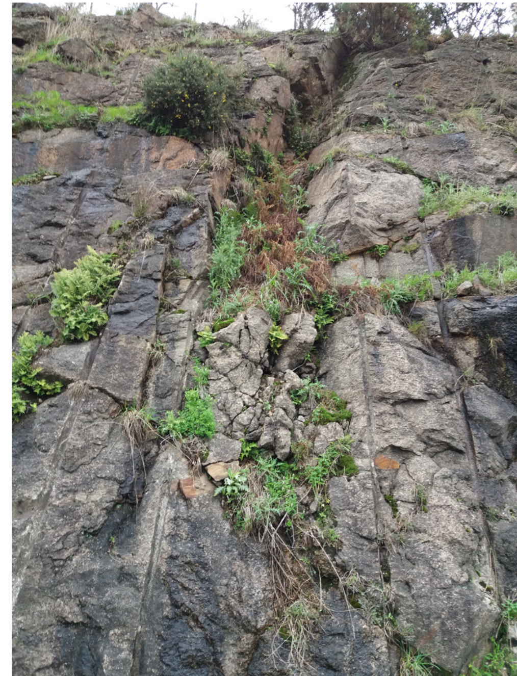
Fotografía 13. Cuña desprendida en la cabecera del talud
