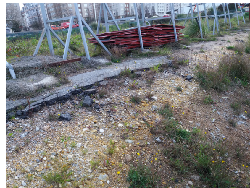
Fotografía 2. Aparcamiento abandonado en un solar localizado a la derecha de la traza, hacia el PK.0+400 del Eje-1. Obsérvese el nivel de zahorra bajo la capa asfáltica.
