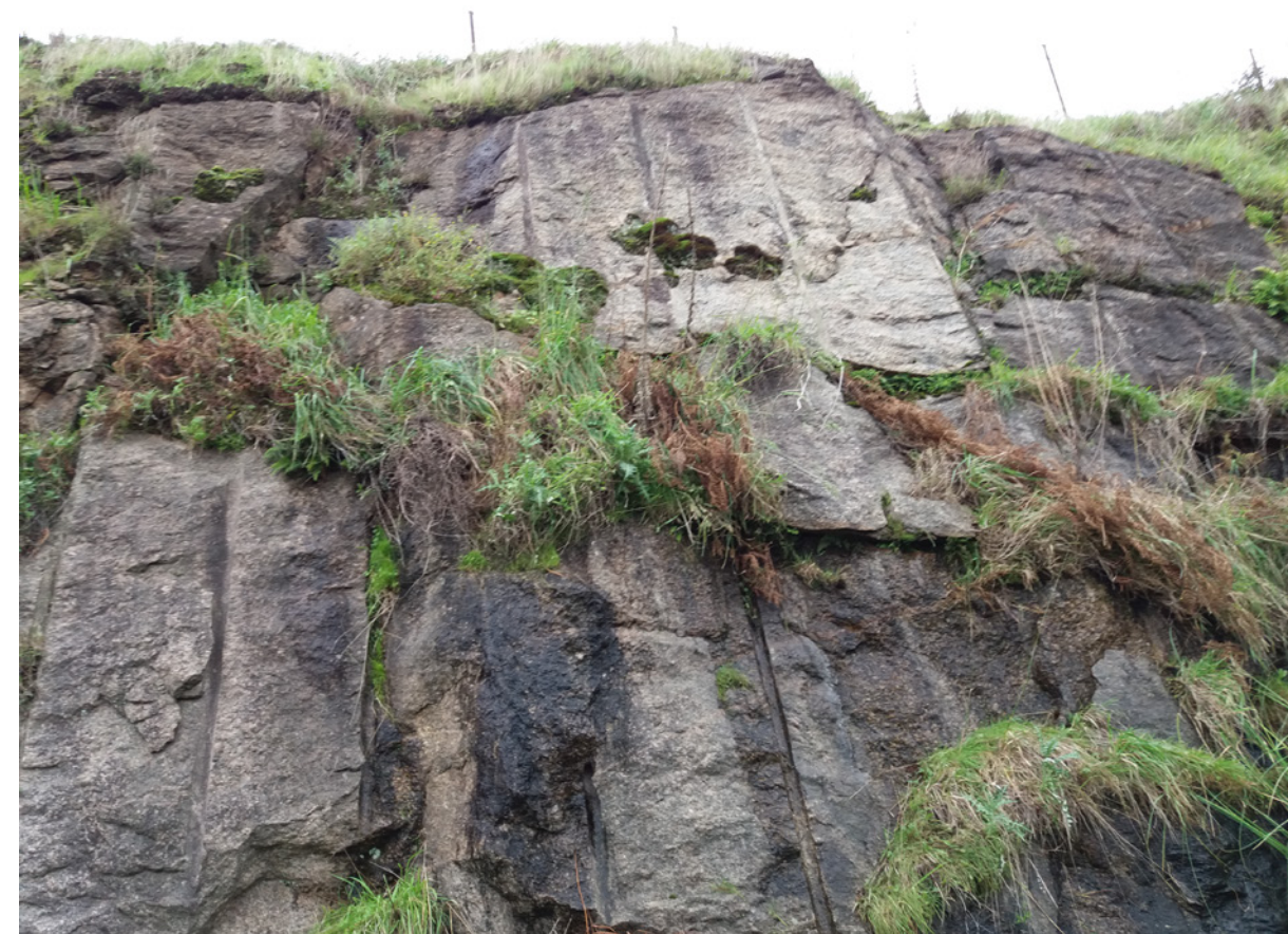
Fotografía 16. “Cañas” de voladura en granodioritas sanas. Desmonte situado en el Eje-11, hacia el PK.-0+900.
