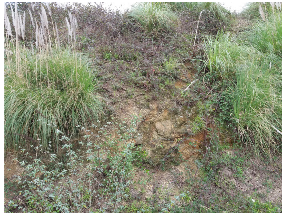
Fotografía 11. Granodiorita alterada en grado IV. Eje-11.PK.1+040
