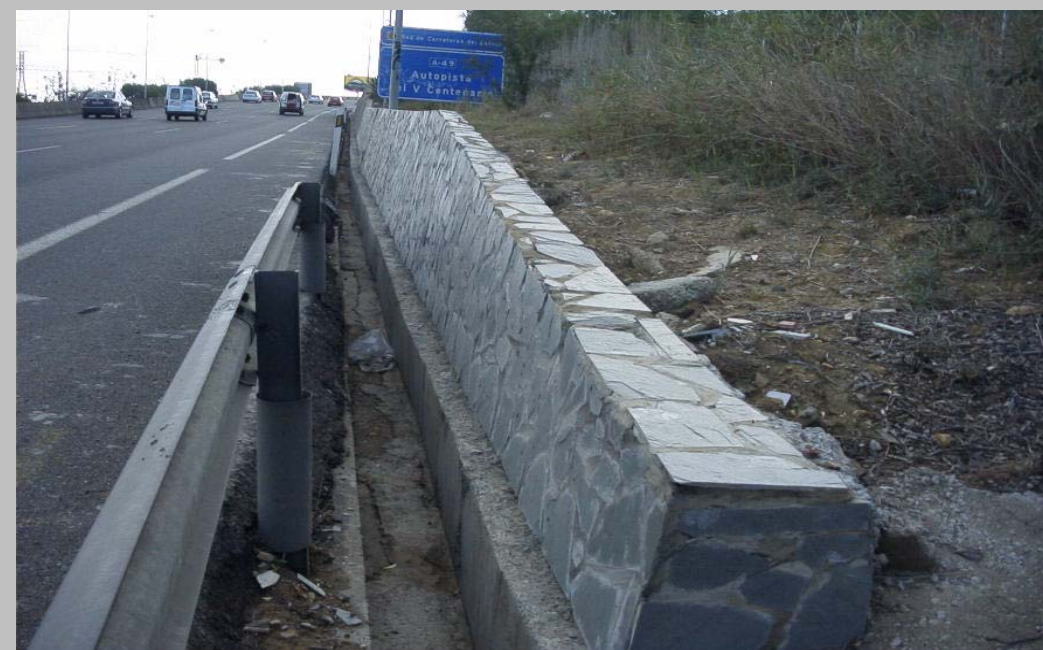
FOTO N° 2. Cuneta con recubrimiento de hormigón y murete de contención en la A-49.
