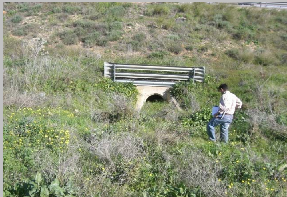
FOTO N° 57. Embocadura en la entrada OTDL 17 con 1 \Phi 1000 mm.. No se afecta con la actuación
