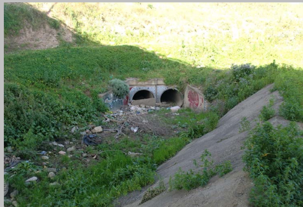
FOTO N° 38. Embocadura salida ODT 14 con 2 \Phi 1200 mm. No se afecta con la actuación.
