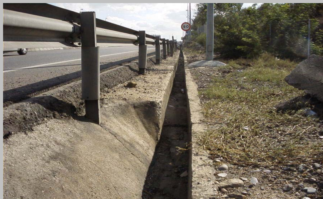
FOTO N° 13. Cuneta rectangular en la A-49. Se afecta este tramo con la actuación. Se repondrá la cuneta .
