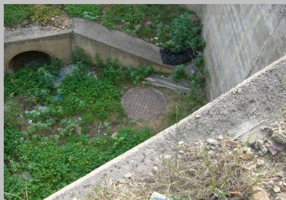
FOTO N° 36. Embocadura en la entrada a la OTDL 24 de 1 Φ 800 mm bajo ramal Sevilla - Mérida para el drenaje del interior del enlace. No se afecta con la actuación
