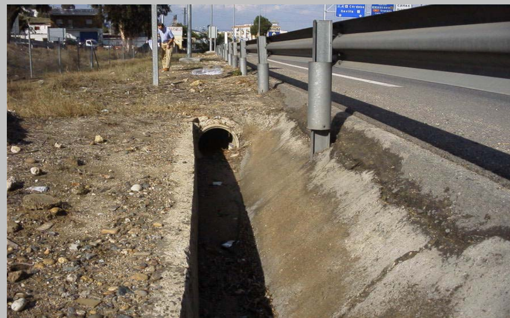
FOTO N° 14. OTDL 7.1 existente. Se afecta con la actuación. Se anula.
