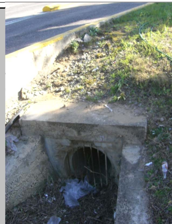
FOTO N° 30. Embocadura con rejilla en la entrada a colector \Phi 500 mm junto al acceso al aparcamiento de Carrefour de Camas. OTDL 8
