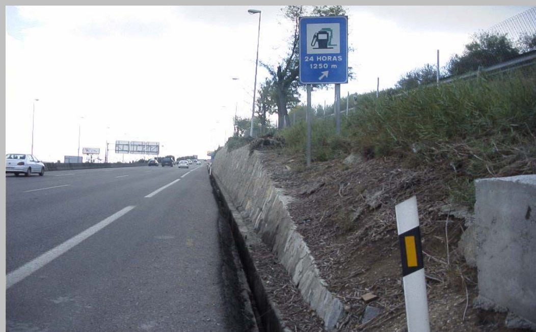
FOTO Nº 7. Cuneta con recubrimiento de hormigón Aguas abajo se afecta por el nuevo carril.
