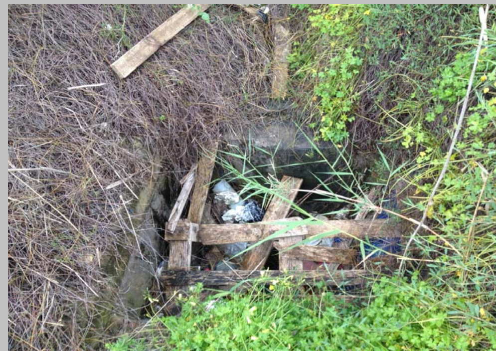
FOTO N° 24. Arqueta de entrada de la ODT2 de 1 Ø 800 mm bajo la glorieta 1 (Camas). No se afecta con la actuación.
