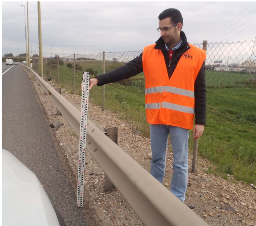
Barrera simple en ramal Huelva-Cádiz con altura inferior a 70 cm.
