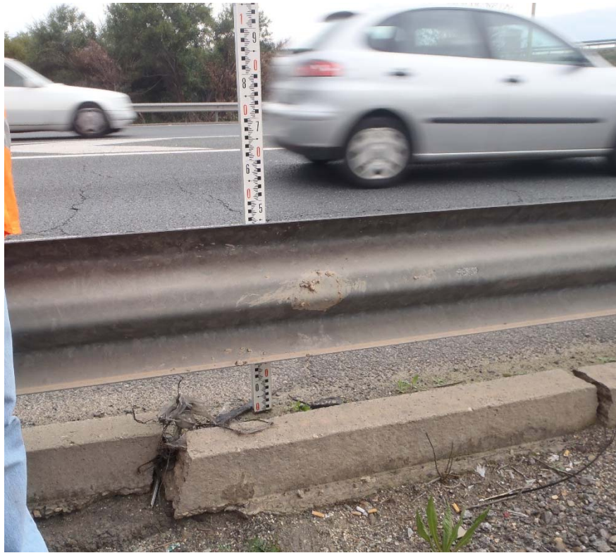
Barrera simple en ramal Huelva-Cádiz con altura inferior a 70 cm.
