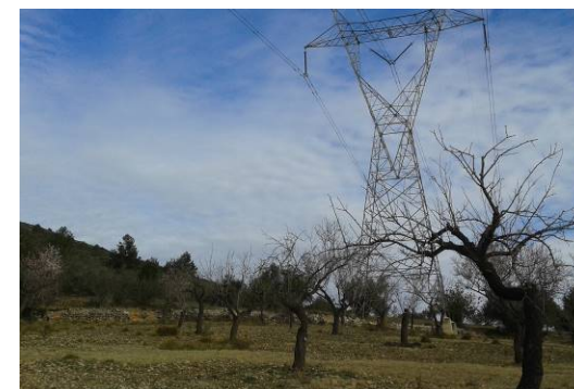
Foto 1. Torre de línea aérea de alta tensión, en el entorno del P.K. 13+600 del trazado.
