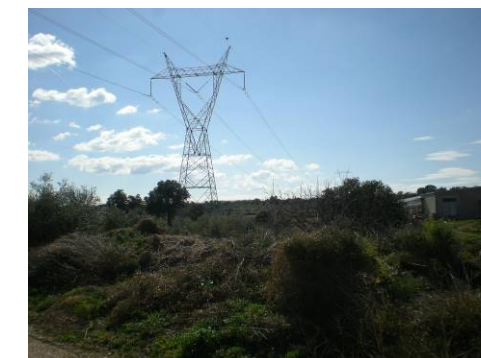
Foto 2. Torre de línea aérea de alta tensión, en el entorno del P.K. 3+000 del trazado.
