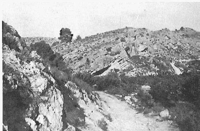
Foto 11 (87P-5) Puerto Almagro Erosión diferencial entre molasas y areniscas que origina caída de bloques. En el valle, margas.
