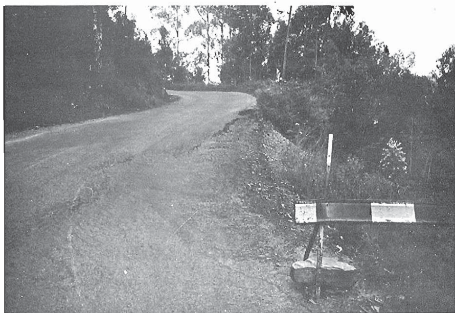
Foto 14.— Deslizamiento en la carretera del Puntal a Ranas, Km 1,300. C:15-3.
