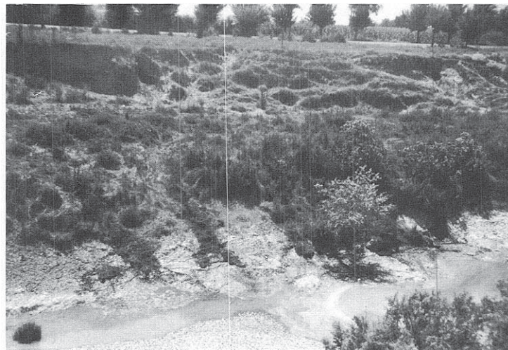
Cantera de Carmona-Lora del Río, p.k. 23,500. Gravera y deslizamiento en la margen izquierda del Guadalquivir.
