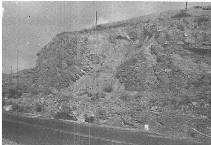
Foto 35.- Derrumbamiento de algunos taludes artificiales verticales excavados sobre el "C. Alpujárride" (grupo 0Ai) en el P.K. 86 de la C.N.-342. Hoja 974-1. (103H-23).
