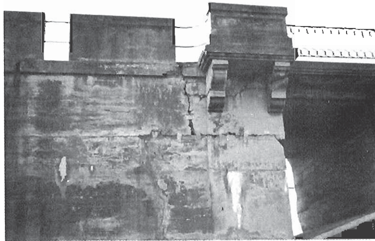
Fig. 10. Foto del puente de San Adrián, con resquebrajaduras a causa del hundimiento del sustrato
