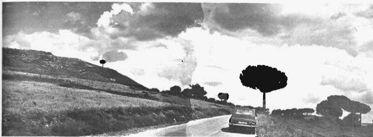
Foto 29.— Desprendimiento de bloques en la formación caliza terciaria 30h, junto a la carretera local de Villar de Cañas a la C.N. III. Hoja 661–1. (100H–36 y 38).
