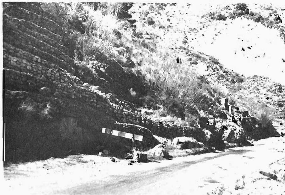
Foto 23.—Importante deslizamiento en la carretera nacional 240 de Huesca a Pamplona, a la entrada de la garganta del río Gállego (313d).
