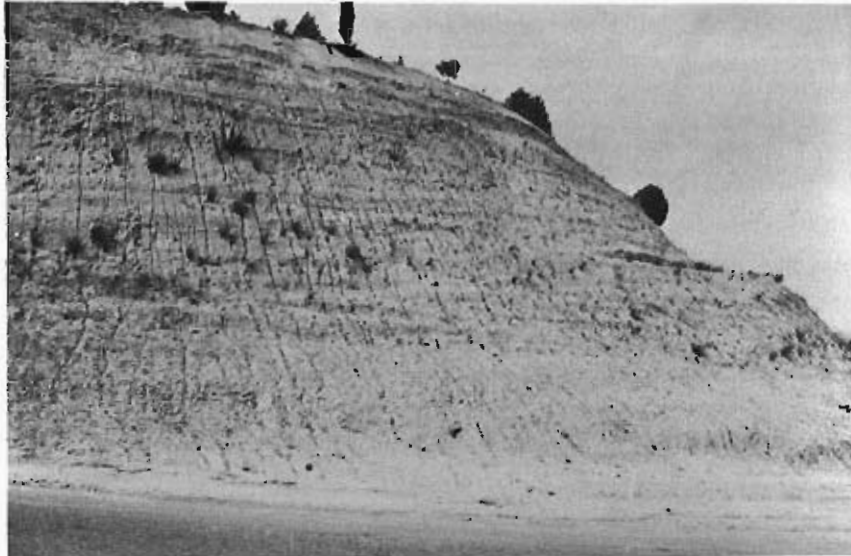
Foto 26.— Desmonte en los materiales areno-limosos del grupo 321 b con abarrancamiento y erosión. (Carretera local de Talavera de la Reina a los Navalmorales).
