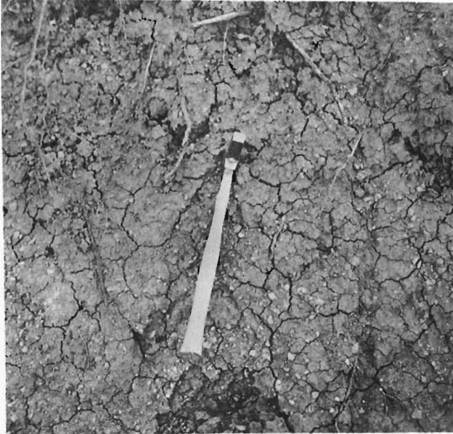
Foto 17.— Arcillas rojizas con algo de gravillas y gravas (350 a). (Carretera de Navalmoral de la Mata a Guadalupe).
