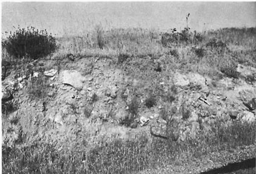
Foto 23.— Desmonte en los materiales del grupo 321 a con gravas, bolos, bloques de naturaleza granítica y silíceas, en las proximidades del borde con las elevaciones del zócalo granítico—metamórfico. (Carretera local de Castillo de Bayuela a Cardiel de los Montes).
