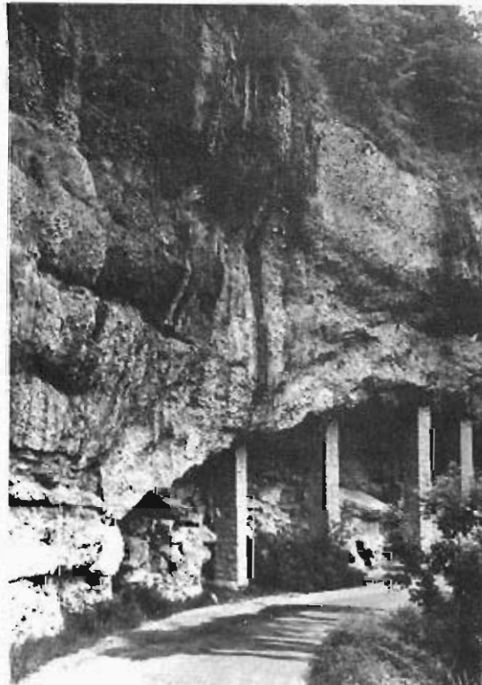
Fig. 65. Problemas de descalces en los conglomerados del grupo 321c5.
