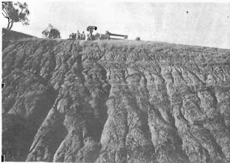
Foto 45.— Taludes con una fuerte erosión lineal en el tramo paleógeno de Casabermeja. Hoja 1039—3.
