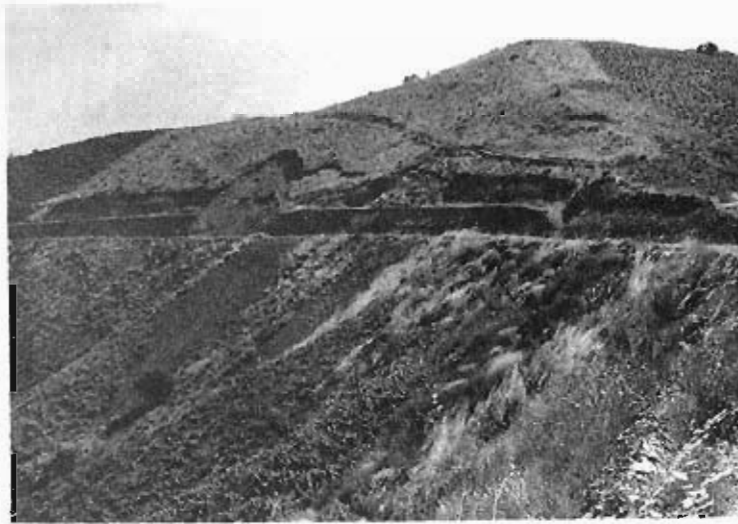
Foto 68.— Deslizamiento de un coluvión tipo C8 en la Carretera de Almachar a Moclinejo, donde estos suelos aparecen bastante continuos y potentes. Cuadrante 1053-1.
