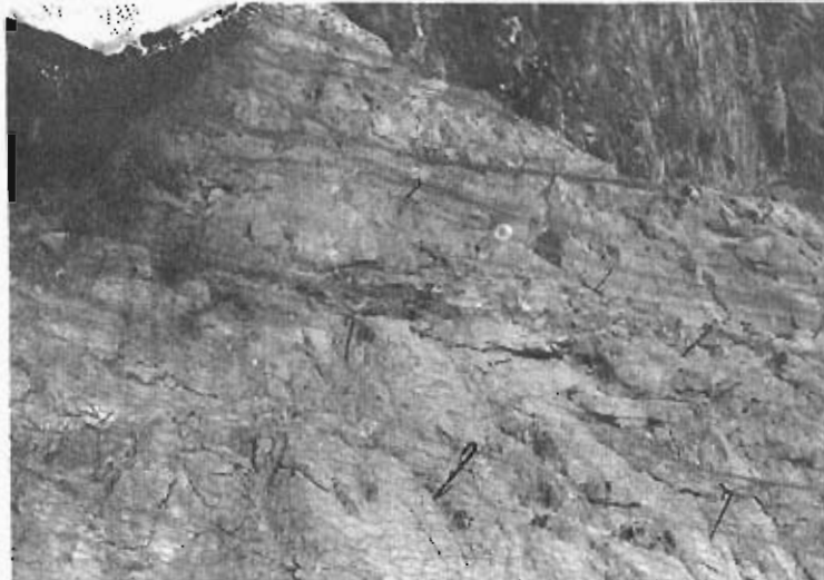
Foto 28.— Talud en calizas jurásicas (220) con redes metálicas para prevenir el desprendimiento de bloques. Hoja 1007—1.
