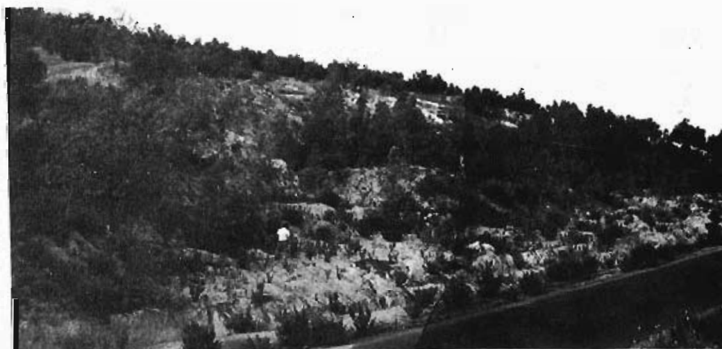
Foto 21.— Zona de deslizamientos y erosiones en los coluviales desarrollados sobre las margas abigarradas del Nummulítico de Rute (grupo 312b). Cuadrante 1007—4.
