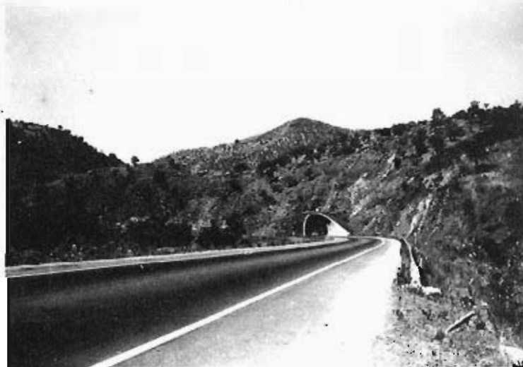
Foto 67.— Taludes con bermas en la embocadura norte en el túnel de la C.N. de Málaga por Casabermeja, P.K. aproximado 540. Paleozoico (150a). Hoja 1039—3.
