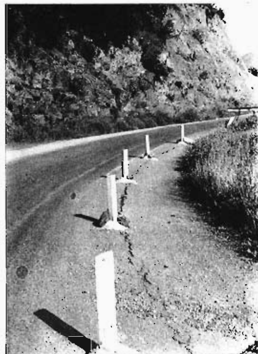
Foto 84.— Agrietamiento del arcén (020 d) en la C a de S. Pedro de Alcántara a Ronda
