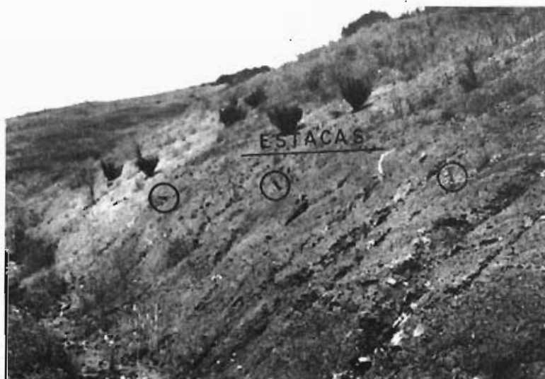
Foto 10.— Movimiento en los taludes del grupo 321 a.
