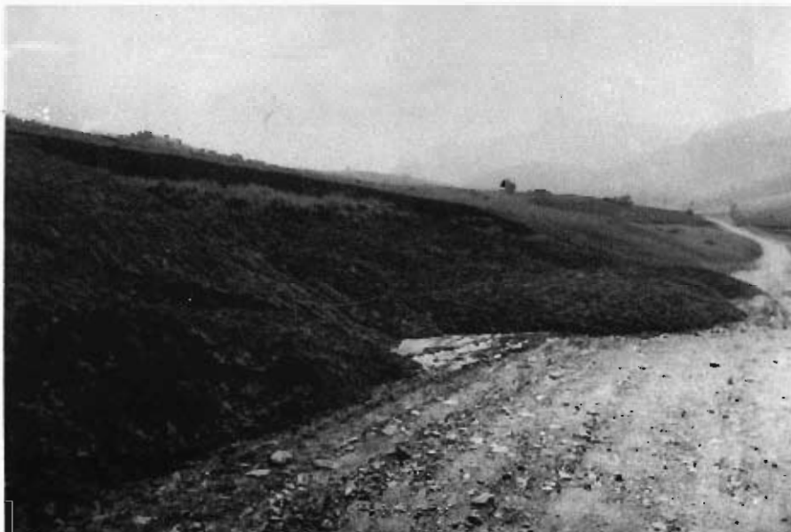
Foto 13. Concha y lengua de deslizamiento en el seno de un talud artificial del grupo 312a. Ctra. local de Ronda a la estación de Benaoljan.
