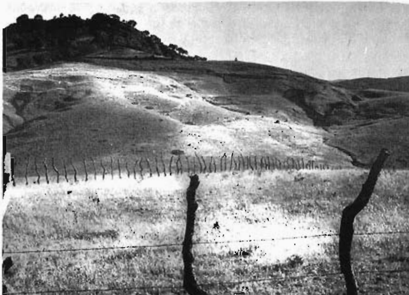
Foto 6.- Margas de Jimena de la frontera (313c). Deslizamientos y abarrancamientos locales importantes junto a esta localidad.
