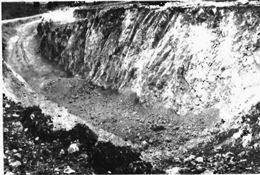
Foto 49. Tramo calizo con buzamientos fuertes. Obras de mejora del trazado de la Ctra. de Ronda a San Pedro.
