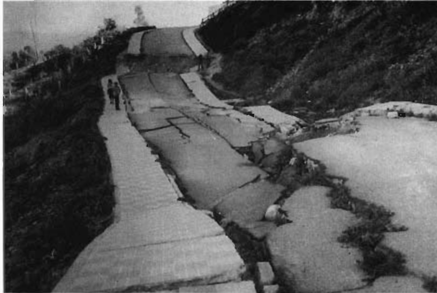
Foto 5. Deslizamiento a favor de la pendiente de un tramo de una vía urbana en Jimena de la frontera.
