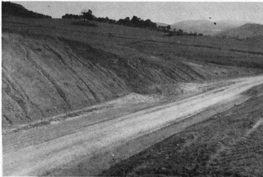
Foto 22. Taludes inestables en el seno del grupo CV 1 entre Ronda y Benaolan.
