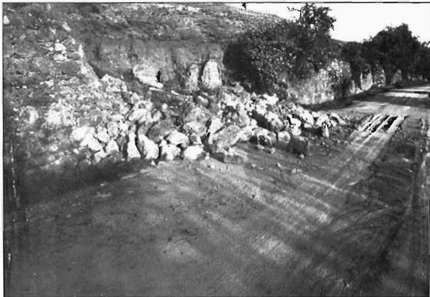
Foto 44.— Deslizamiento del muro de mampostería en el bancal y obstrucción parcial de la carretera.
