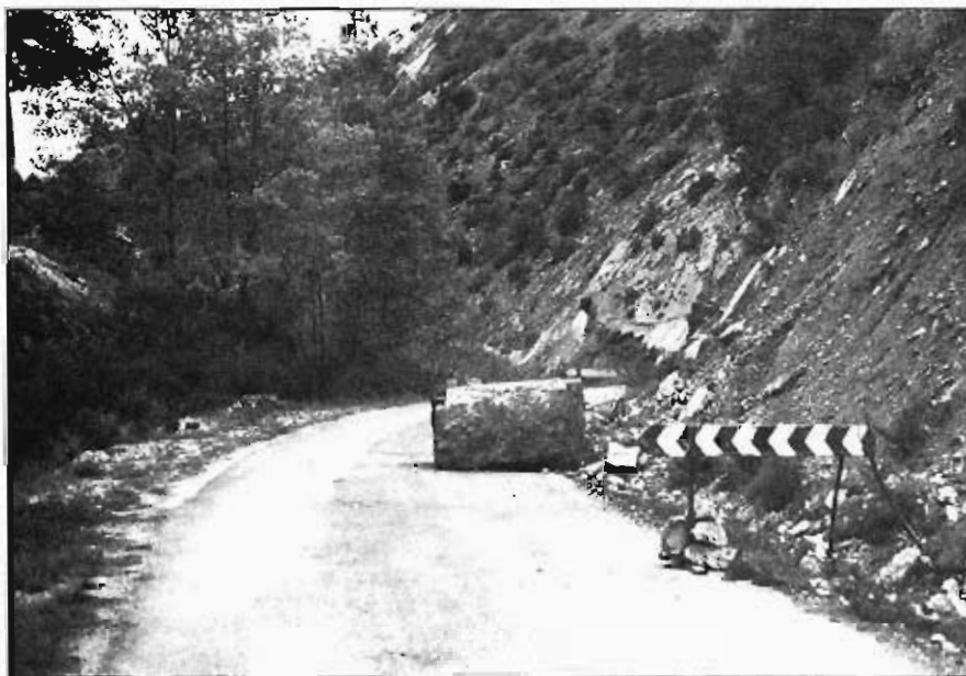
Foto 53.— Grupo 212a. Deslizamiento plano en las dolomías del Muschelkalk. Obstrucción parcial de la carretera.
