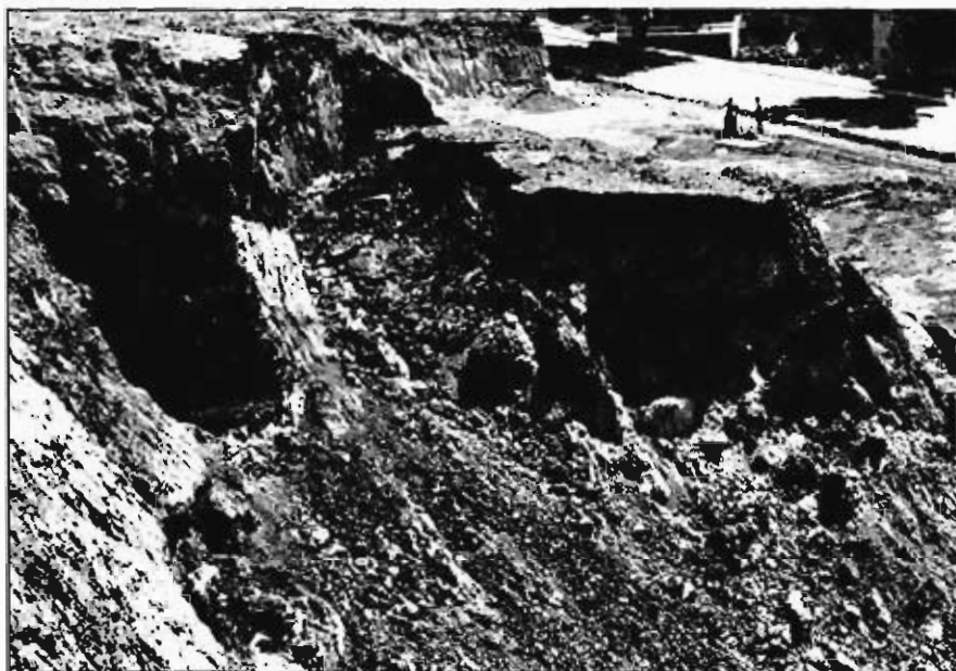
Foto 45.— Deslizamiento en una formación triásica al efectuar una excavación vertical sin entibación.
