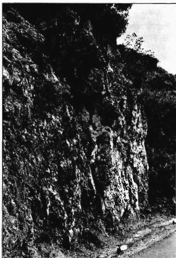
Foto 24.— Grupo 221a. Nótese el desprendimiento latente de la masa dolomítica por efecto del diaclasado existente.
