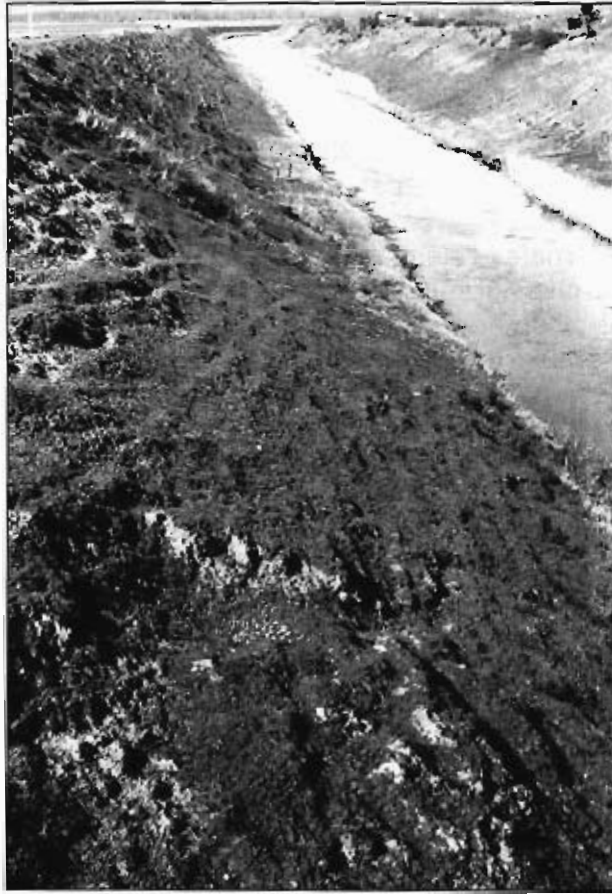
Foto 39.— Canal de Castilla en su cruce con la carretera local que enlaza los pueblos de Osornillo y Osorno. El cauce está excavado en arcillas y limos con intercalaciones arenosas, del grupo 321h. A pesar de lo tendido de sus taludes, se observa una inestabilidad generalizada de los mismos.
