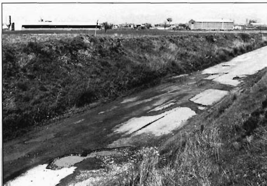
Foto 36.— Surgencias de agua en el contacto entre la terraza del grupo T3 y el grupo 321h, junto a la población de Arenillas de Ríopisuerga. La carretera se ve afectada por este hecho al no existir un drenaje efectivo de las aguas.
