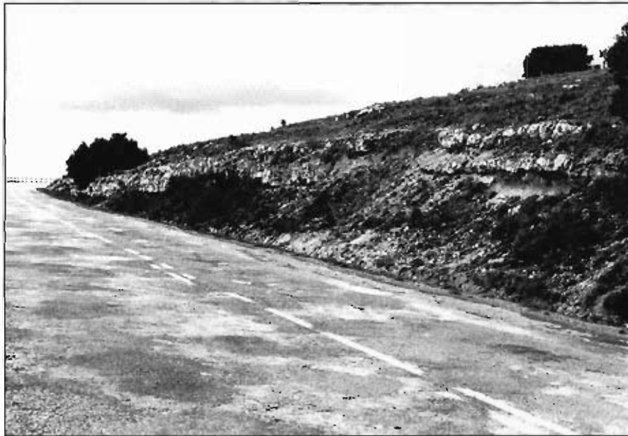
Foto 13.— Alternancia de estratos calizos y margas del grupo 321c sobre las margas del grupo 321e que configuran la base del talud. Inicio del descenso de la carretera N-120 desde el páramo inferior al valle del río Hormazuelas por la ladera de la margen izquierda del arroyo del Plantío.
