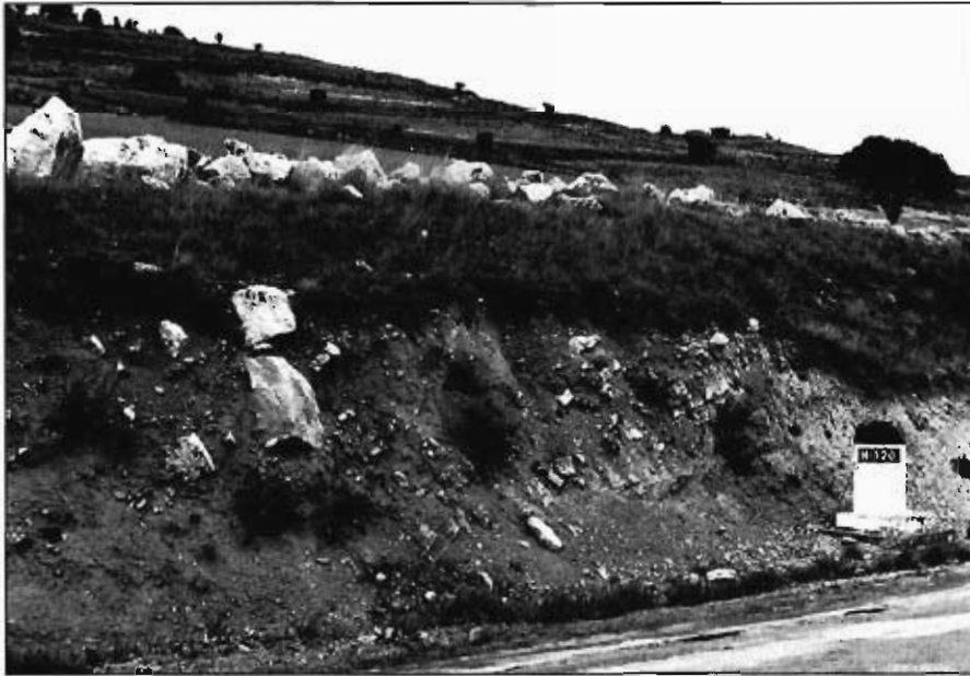
Foto 7.— Coluviones con bloques calizos procedentes de desprendimientos de las cornisas del páramo, sobre un sustrato calizo y margoso basculado, a consecuencia de una inestabilidad pretérita. Laderas de la margen izquierda del arroyo del Plantío, a la altura del p.k. 137 de la carretera N-120 según el Mapa General 1:50.000 del Servicio Geográfico del Ejército.
