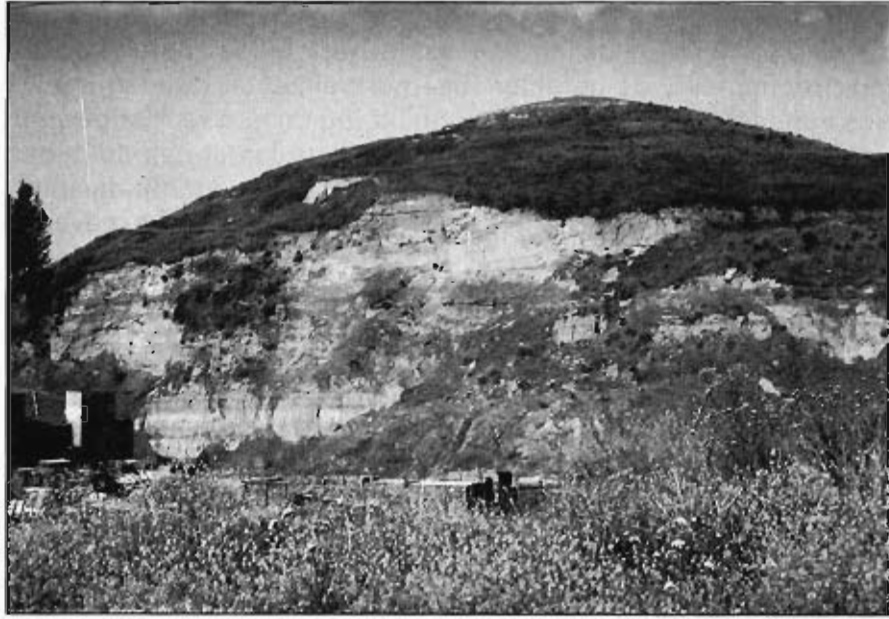
Foto 30.— Frente de una explotación de arcillas del grupo 321h a la salida de Burgos en dirección Santander. En la ladera natural se aprecian fuertes cambios de pendiente motivados por deslizamientos fósiles y actuales, y en la pared del desmonte, claras muestras de surgencias de agua. La inestabilidad, reactivada y creada por la importante excavación, es manifiesta en el perfil natural de la ladera.
