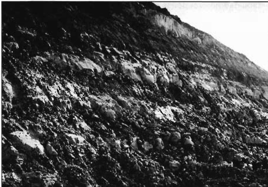
Foto 19.— Talud excavado en las margas y margo-calizas con horizontes intercalados arenosos, correspondientes al grupo 321e. Forma parte de las obras de mejora del trazado que se efectúan en la carretera N-120, a la altura del p.k. 143, y en la margen derecha del arroyo Perú. El agua surge en distintos niveles del desmonte, lo que implica que si este agua no se controla mediante un drenaje adecuado, provocará un deterioro rápido del mismo.
