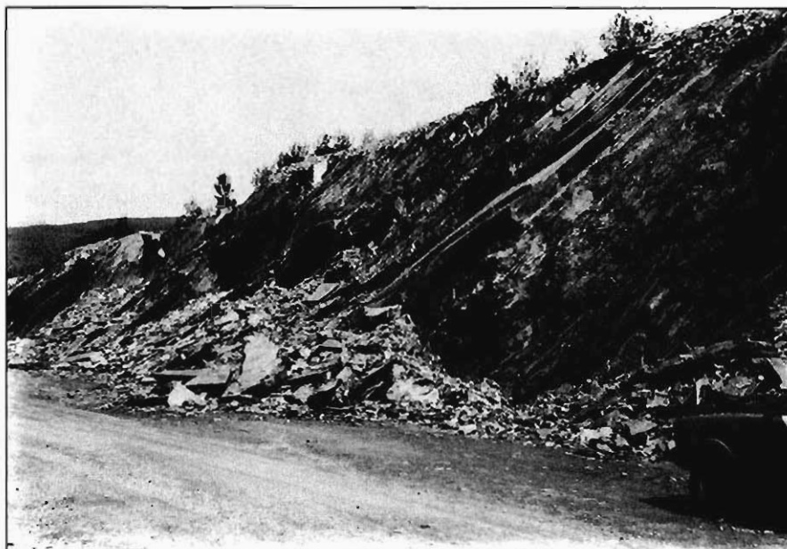
Fig. 4.1.— Deslizamientos de lajas, en un talud de los materiales del grupo (010b), en las proximidades de Granadilla.
