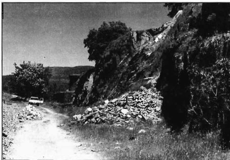
Foto 4.- Grupo (150c). Aspecto de los materiales en la trinchera del ferrocarril de Zafra a Huelva, en el P.K. 78,3.
