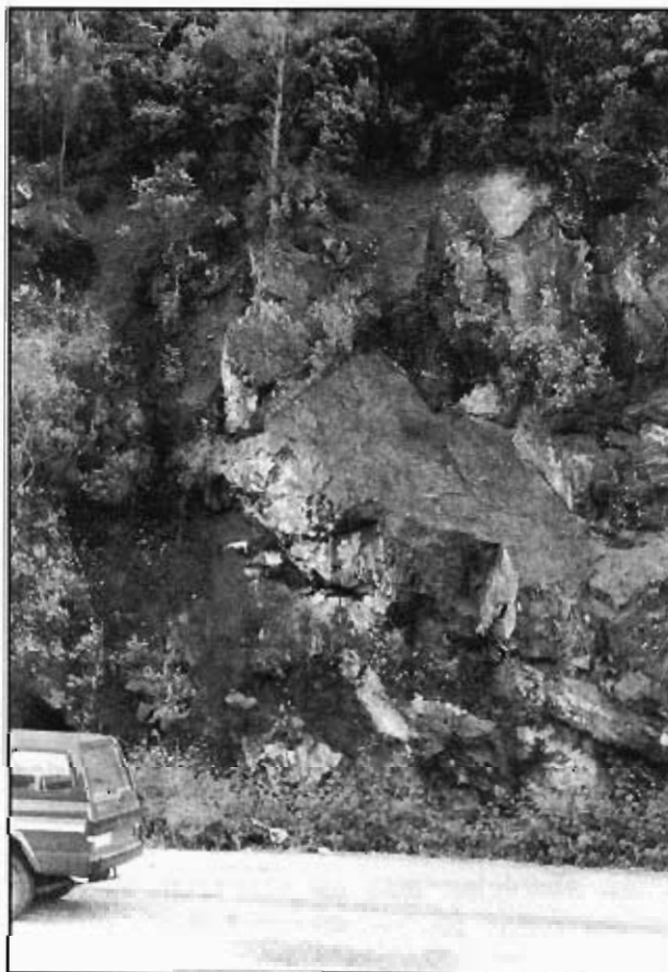
Foto 25.- Desprendimientos potenciales en el grupo 110, en un área con rellenos de arcillas de descalcificación. P.K. 26 de la carretera de Alájar a Aracena.
