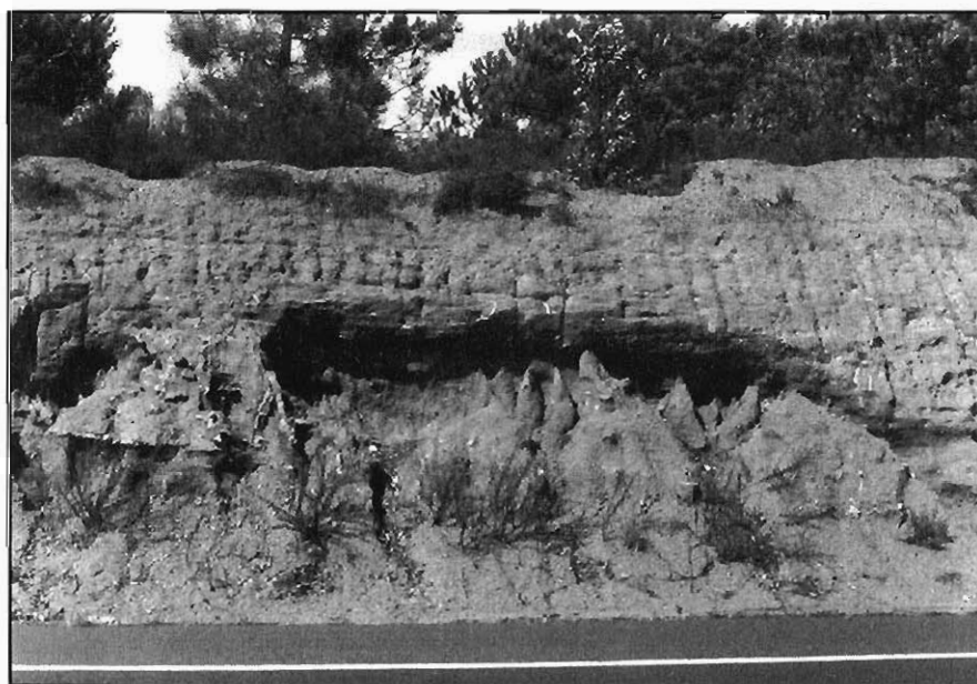
Figura 3.20.- Desmoronamiento del nivel inferior del talud, formado por arenas arcillosas. Talud excavado en los materiales del grupo 350 y localizado en el P.K. 695 de la carretera N-431.
