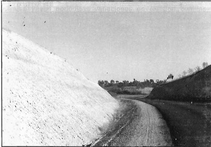
Figura 3.32.- Talud recientemente excavado en la carretera de Trigueros a Bonares. En cada talud existe una berma situada hacia la mitad del mismo.
