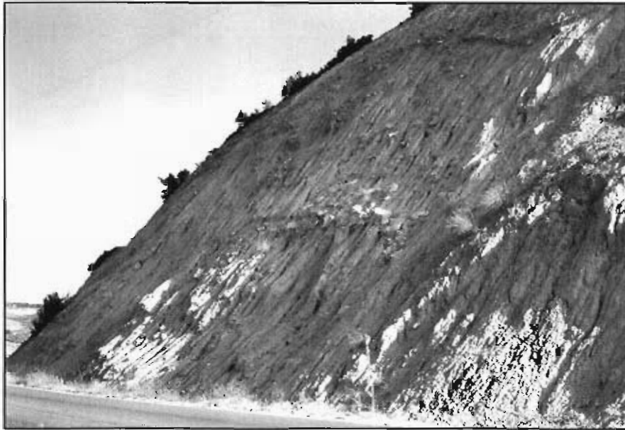
Figura 3.38.- Talud de altura media realizado en los materiales del grupo (232f), en la carretera N-420 y en las proximidades de la localidad de Fuentes (Hoja 635-1).
