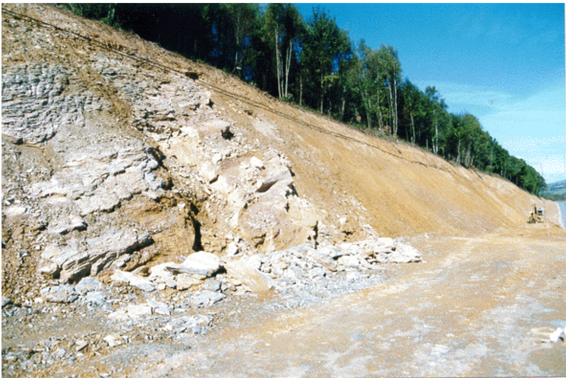
Foto 3.26. Desmonte en (111f), pizarras arcillosas y arenosas con niveles de areniscas, carretera de Meira a Mondoñedo
