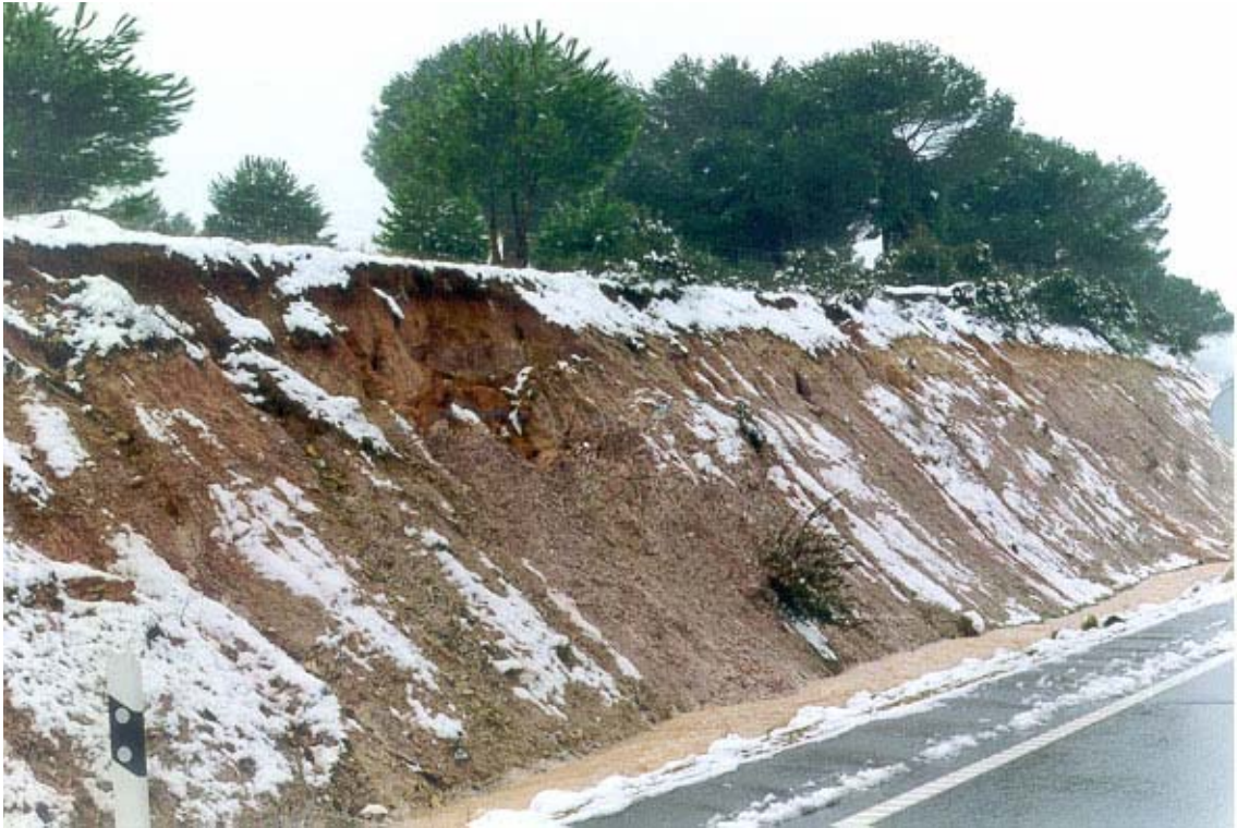
Figura 3.12. Talud excavado en los esquistos silíceos del grupo (121a), en el P.K.466,950 de la carretera N-122. La inestabilidad que se observa en la cabecera del talud se debe a la erosión de los materiales terciarios del grupo (311a), que recubren a los esquistos.
