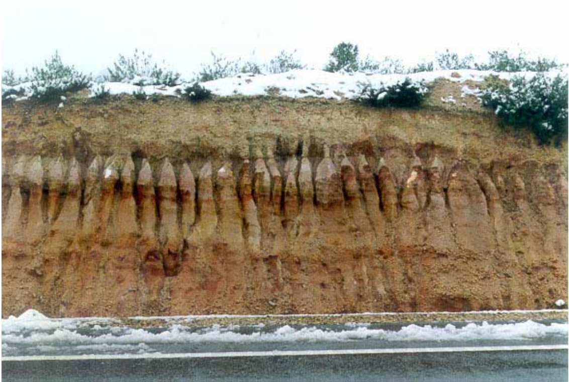
Figura 3.40. Detalle de la erosión en un talud excavado en los materiales del grupo (311a), situado en el P.K.466+500 de la CN-122.
