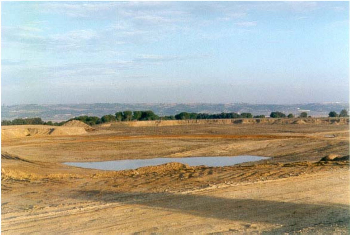
Figura 5.4. Explotación de gravas del grupo (t1), junto a la carretera C-112, en el P.K.23.3.
