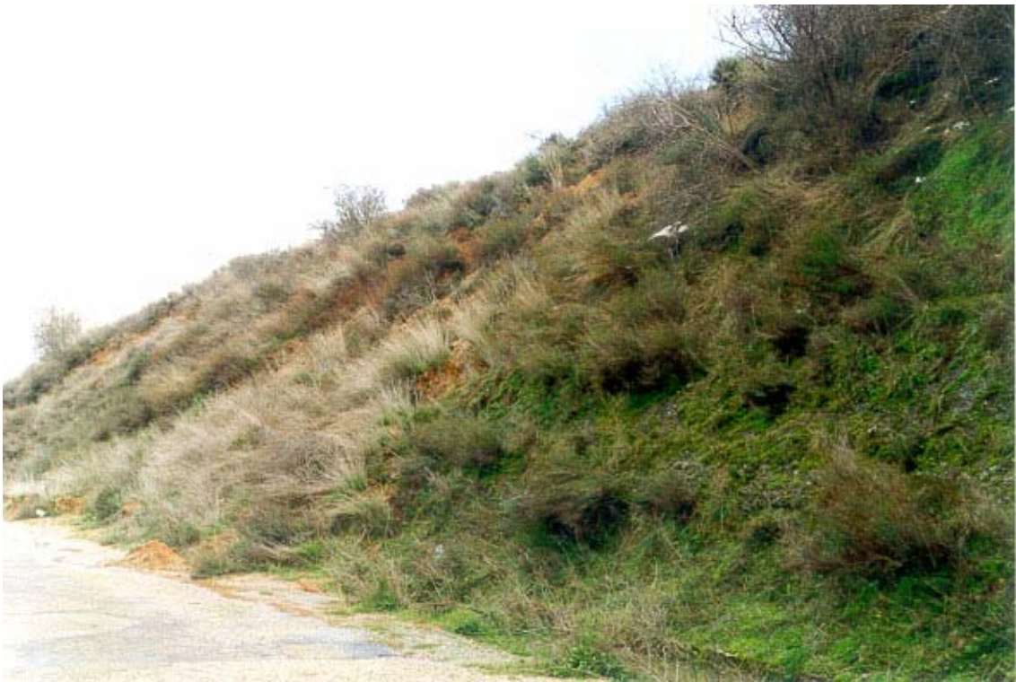
Figura 3.23. Deslizamientos en un talud excavado en las gravas arcillosas del grupo litológico (321a), localizado en una curva abandonada de la carretera N-630, hacia la cola del embalse de Ricobayo.
