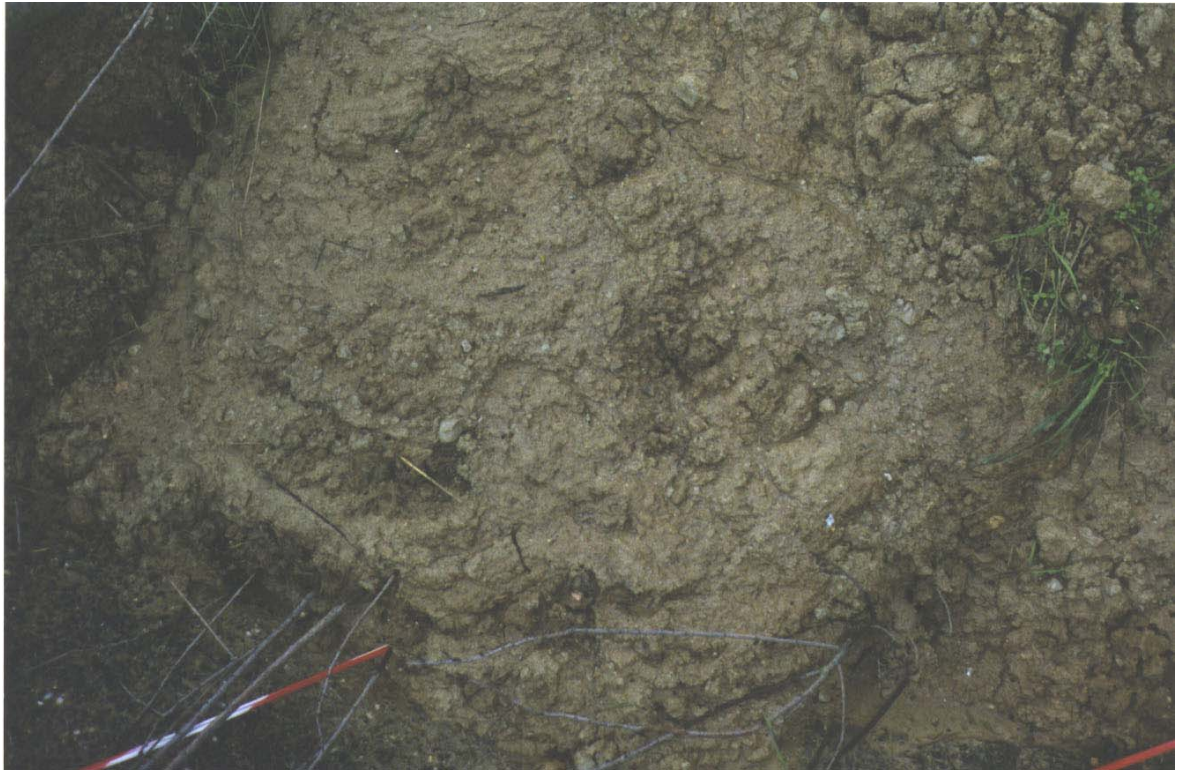
Figura 3.31. Aspecto de detalle del material limo-arcilloso del grupo (312a) que compone el bulbo de material del deslizamiento anterior.
