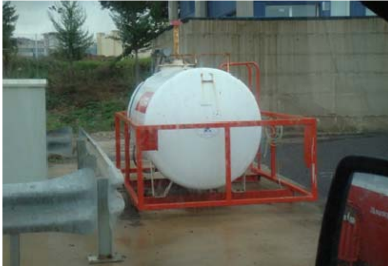
Ilustración 2.20.- Depósito de combustible para equipos handling
