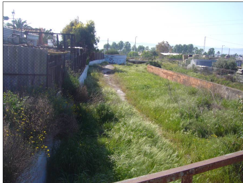
Foto 203. Vista hacia la izquierda del canal que pasa bajo la línea ferroviaria en el P.K. 51+720 (204+570).
