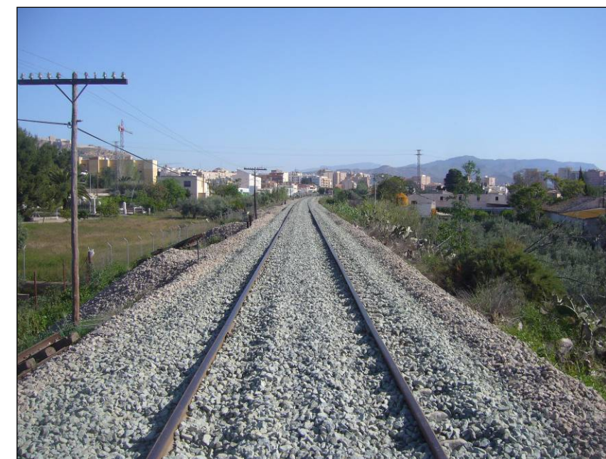
Foto 198. Panorámica de la línea ferroviaria sentido Lorca, en torno al P.K. 51+600 (204+450), donde se aprecia el desnivel entre ambas márgenes.
