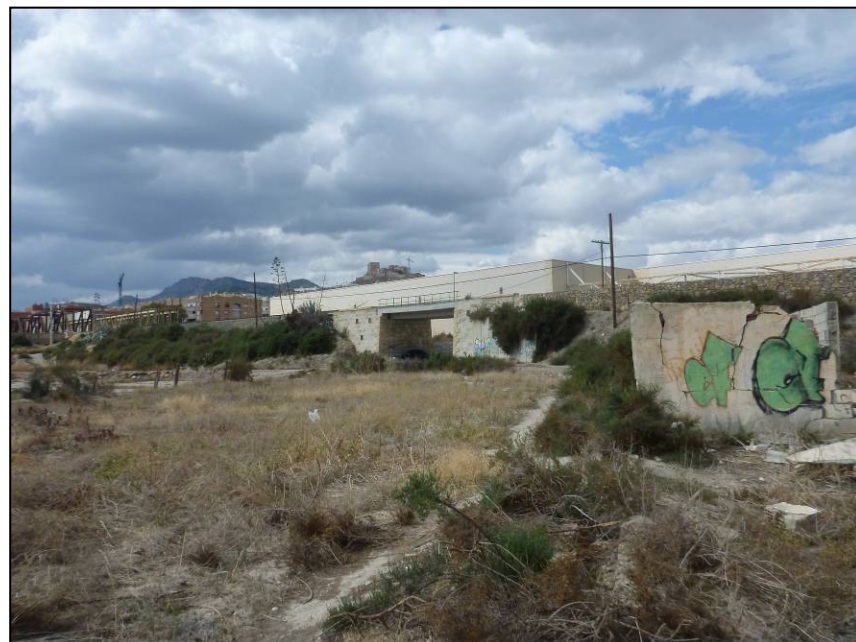
Foto 73. Vista del paso inferior P.K. 49+300 (202+155), desde la margen izquierda de la línea. Se observa el muro de escollera que llega hasta la estructura.
