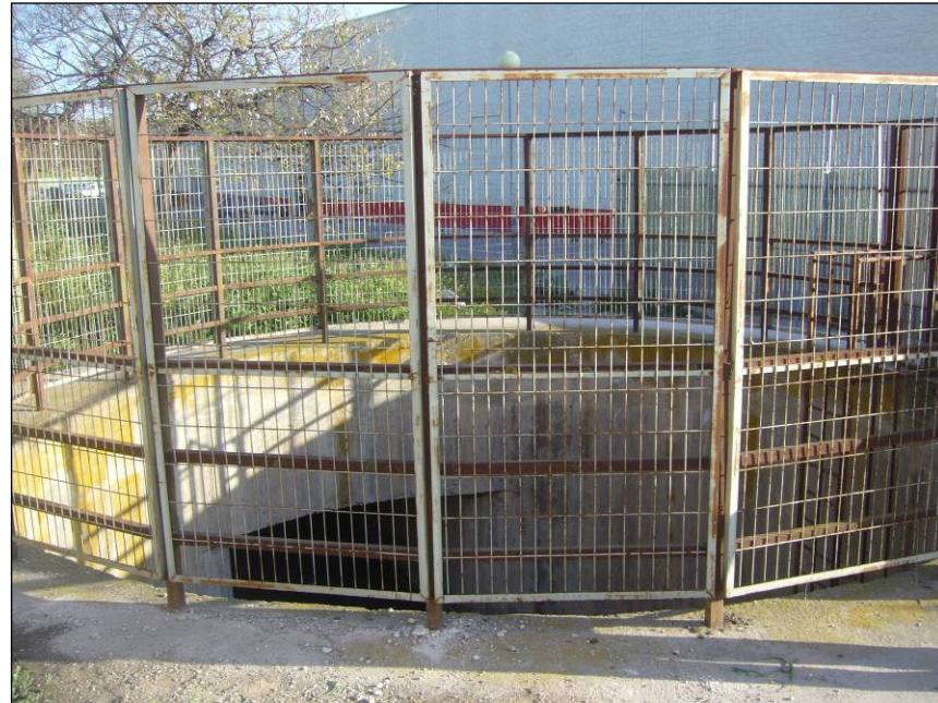
Foto 85. Detalle del pozo de entrada del sifón que cruza bajo el río Guadalentín, perteneciente al Tránsito Tajo - Segura.
