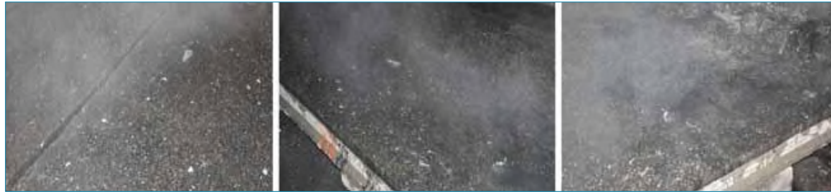
Figura 25:- Estado del firme superficial de la mezcla bituminosa AC16S aditivada con el 1,4% después del ensayo con incendio de un coche.
