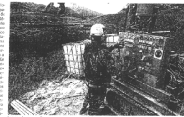
Los sondeos se realizaron ayer a unos metros de la actual N-260, entre Jánovas y Lavellilla. PA.
