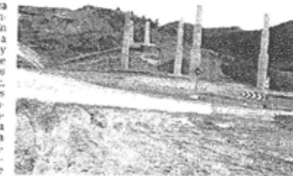
Trabajos en el tramo Jaca-Santa Cilia de la futura autovía A-2. S.A.
