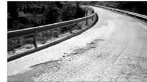
Detalle del mal estado de la calzada, en el tramo afectado por el informe. Foto: EL PERIÓDICO
