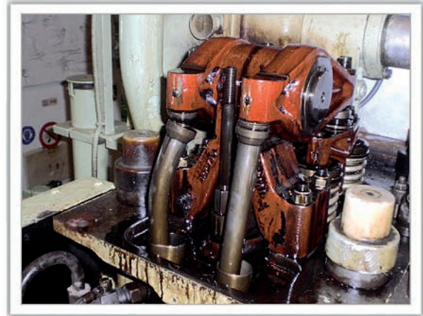
Figura 3. Empujadores de válvulas doblados
