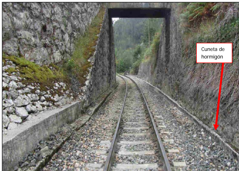
Vista de la zona del lugar del descarrilamiento (PK 451+557). (Fuente: Adif)
