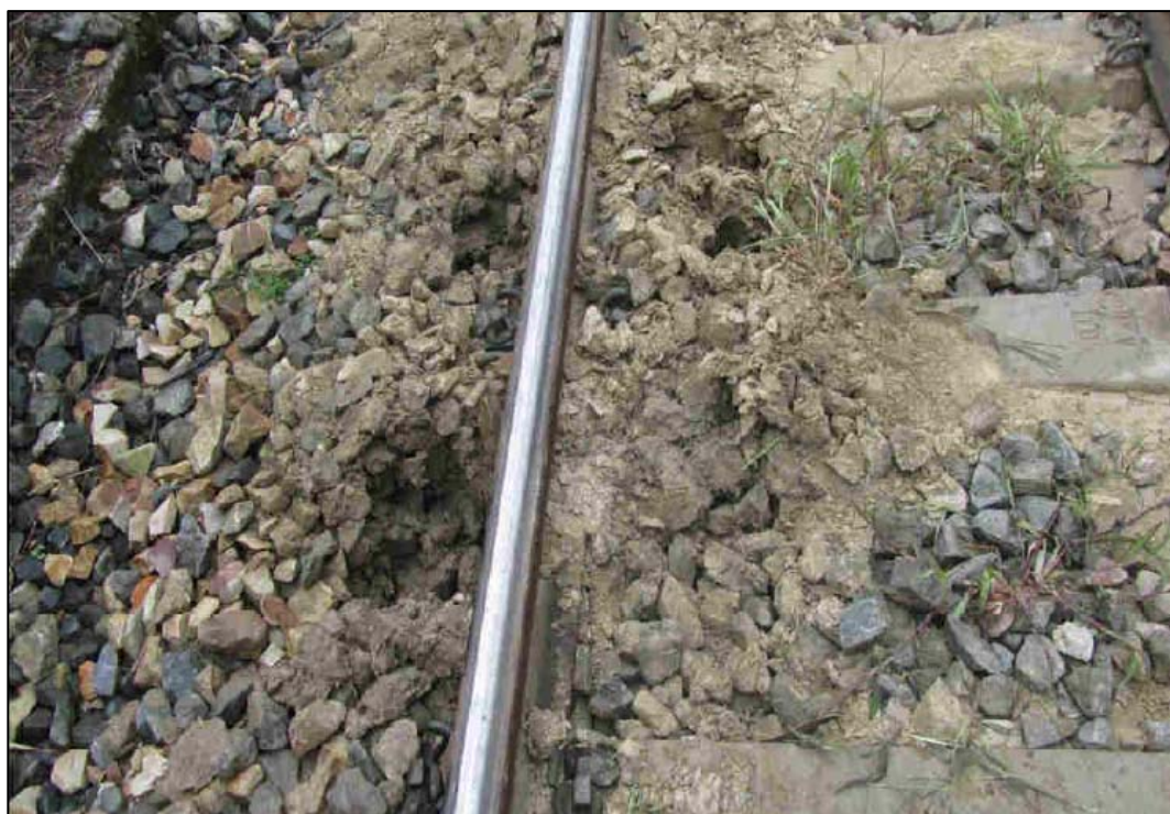
Detalle de la contaminación del balasto en la zona de remonte. (Fuente: Adif)
