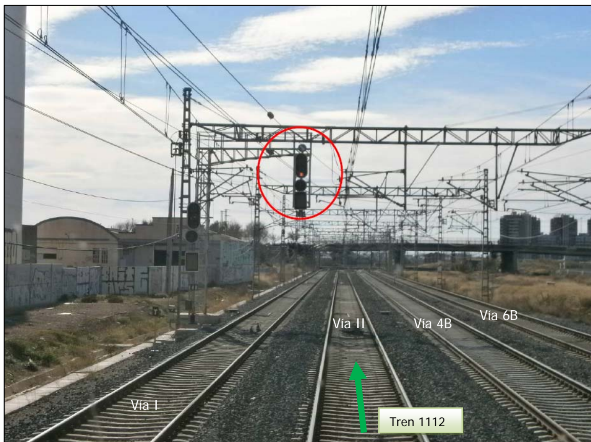
Vista de la señal S2B. (Fuente Adif)
