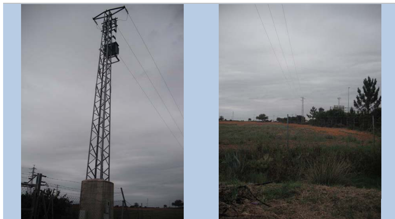
Línea eléctrica paralela al trazado de la carretera provincial HU-4400, que suministra energía a la instalación de alumbrado del enlace de Lepe Oeste
