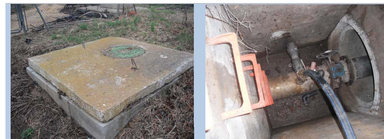
Conducción de fibrocemento de diámetro nominal de 300 mm fuera de uso
