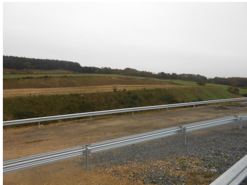
Foto 32: Carril deceleración margen izquierda tramo sin asfaltar.
