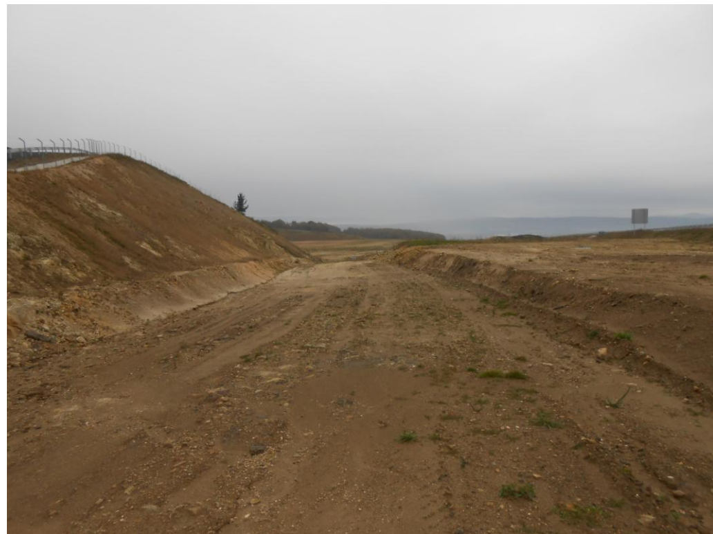
Foto 15: Carril aceleración margen izquierda sin asfaltar.
