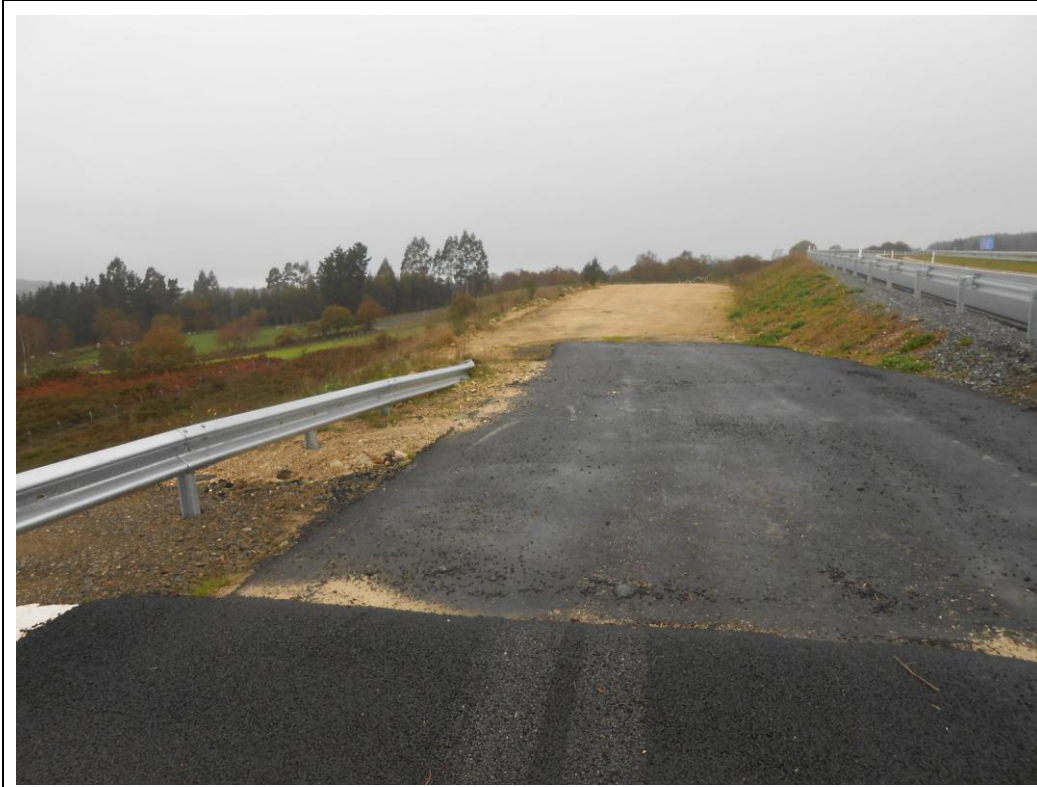
Foto 65: Carril de aceleración tramo sin asfaltar margen derecha.
