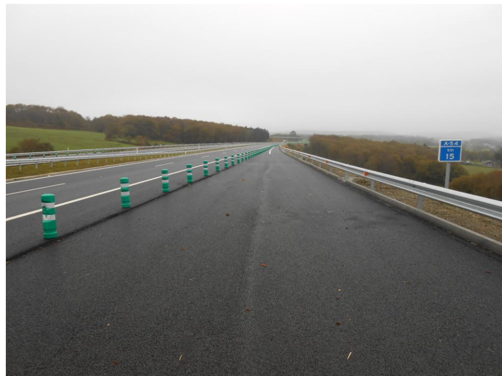
Foto 64: Carril de aceleración tramo asfaltado margen derecha, falta rodadura.
