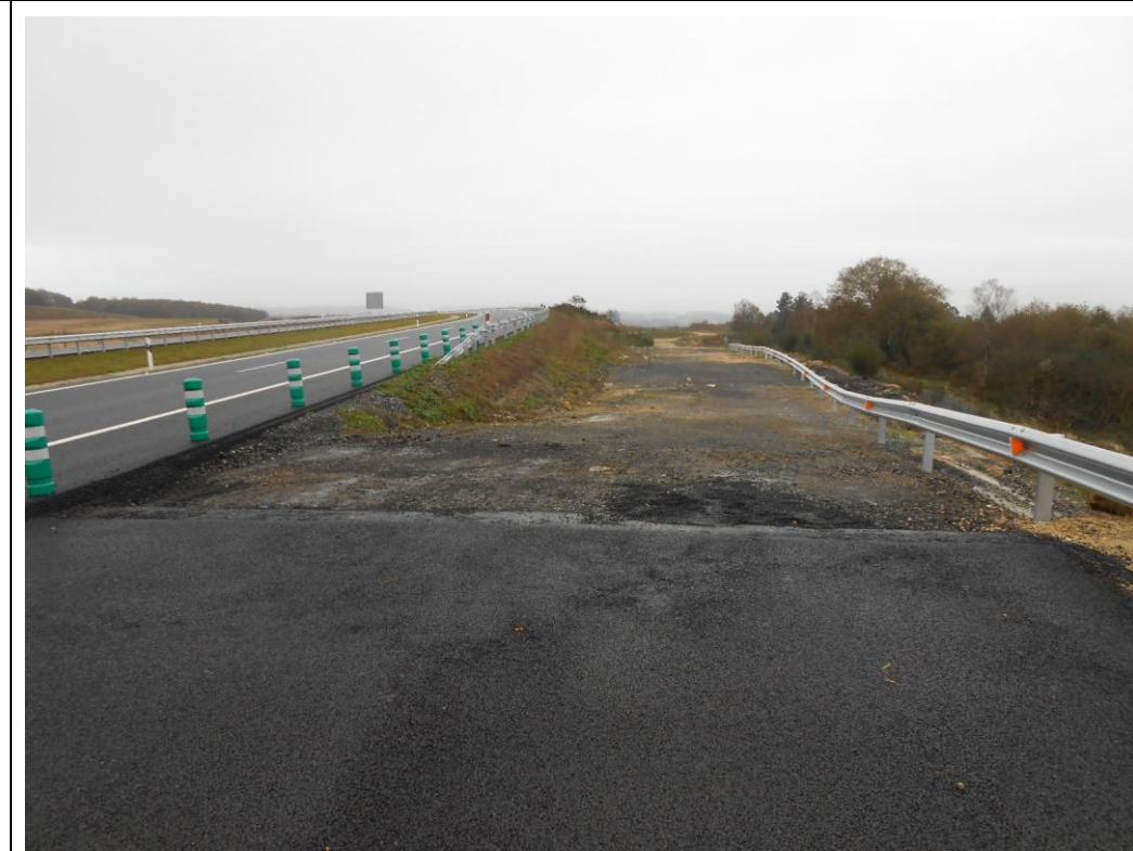
Foto 58: Carril deceleración margen derecha donde comienza el tramo sin asfaltar.
