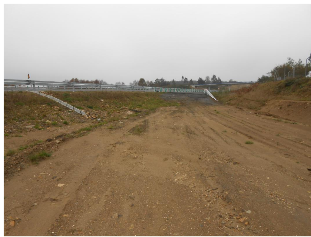
Foto 14: Carril aceleración margen izquierda sin asfaltar.
