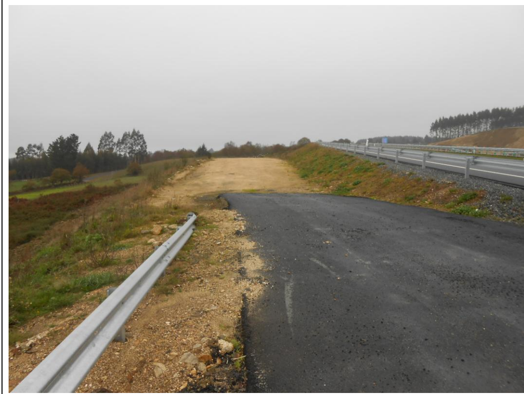
Foto 66: Carril de aceleración tramo sin asfaltar margen derecha.
