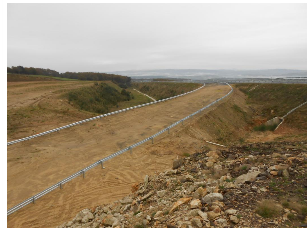
Foto 36: Carril deceleración margen izquierda tramo sin asfaltar.
