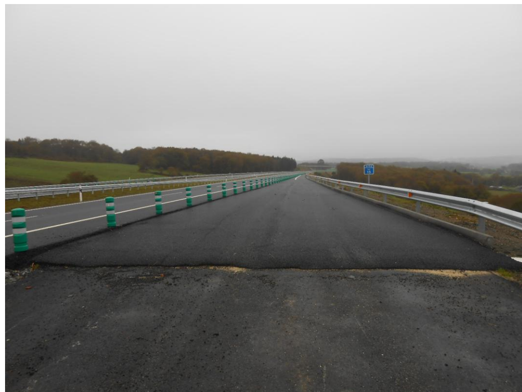
Foto 63: Carril de aceleración fin tramo asfaltado margen derecha, falta rodadura.
