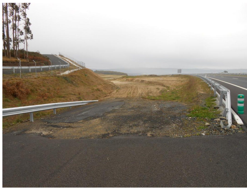
Foto 13: Carril aceleración margen izquierda sin asfaltar.
