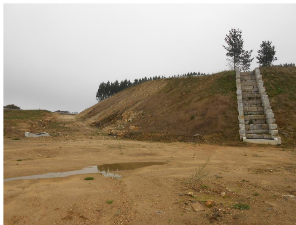
Foto 17: Carril aceleración margen izquierda sin asfaltar, detalle de sumidero y bajante escalonada.
