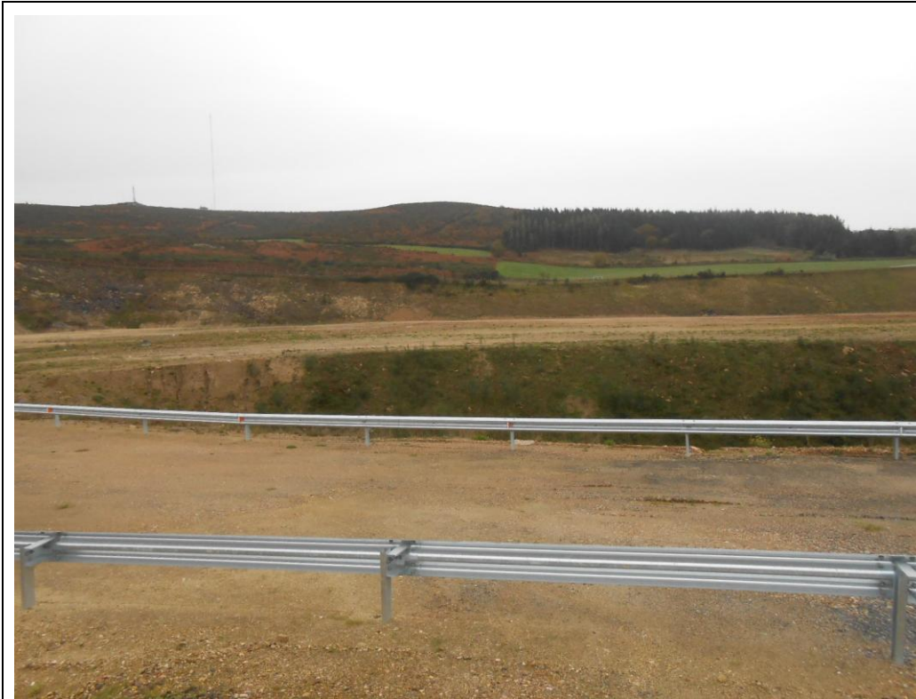
Foto 33: Carril deceleración margen izquierda tramo sin asfaltar.
