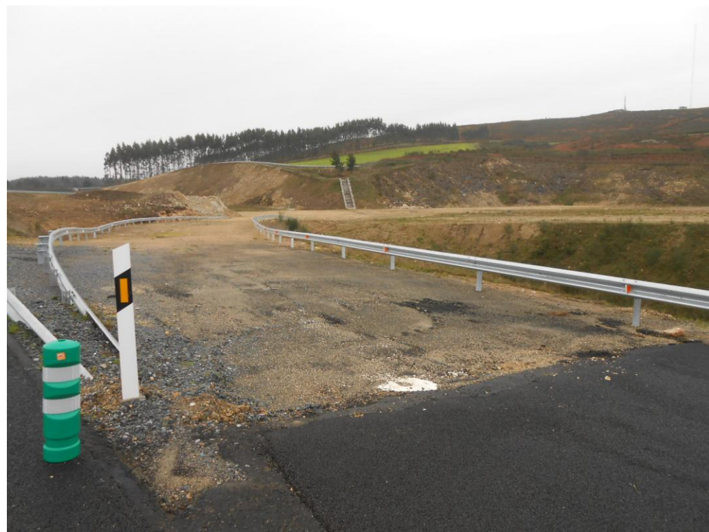
Foto 31: Carril deceleración margen izquierda tramo sin asfaltar.
