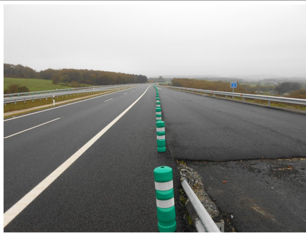
Foto 62: Carril de aceleración tramo asfaltado margen derecha, falta rodadura.
