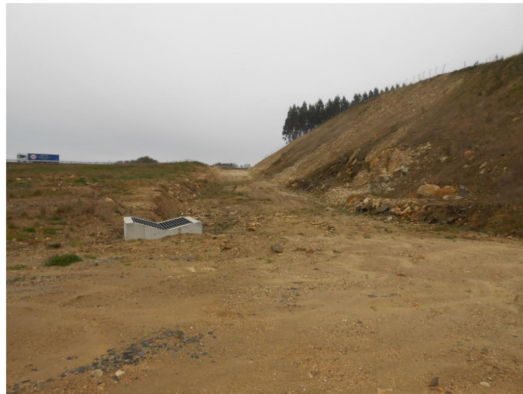
Foto 16: Carril aceleración margen izquierda sin asfaltar y detalle de sumidero.
