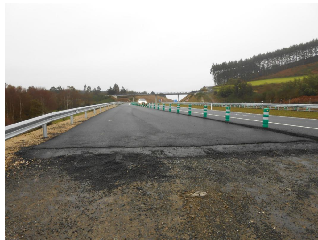
Foto 59: Carril deceleración margen derecha donde comienza el tramo sin asfaltar.
