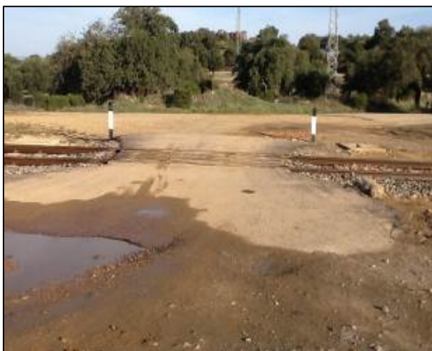
Acceso al paso a nivel por el lado derecho, según el sentido de la marcha del tren.
