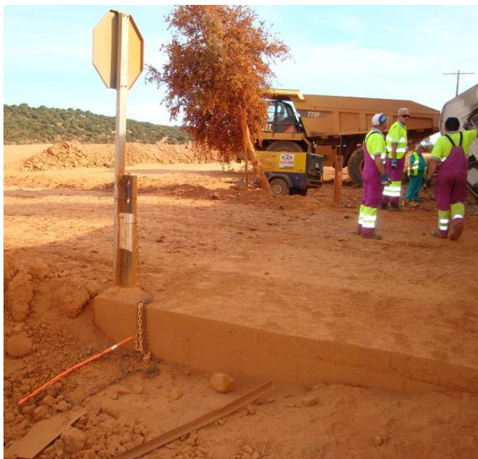
Detalle de candelabro y candado en el lado opuesto al de acceso del dumper accidentado. (Fuente: CIAF)
