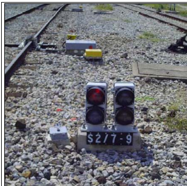
Señal S2/7-9 y calce C23 (Fuente: Renfe Operadora)
