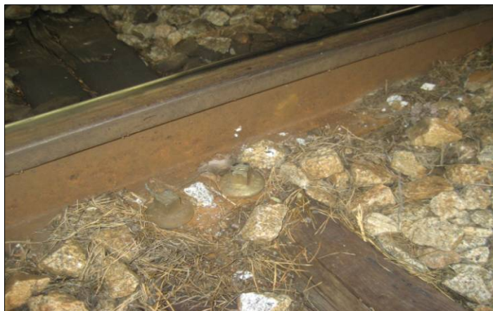
Estado de la vía. (Fuente: Adif)
