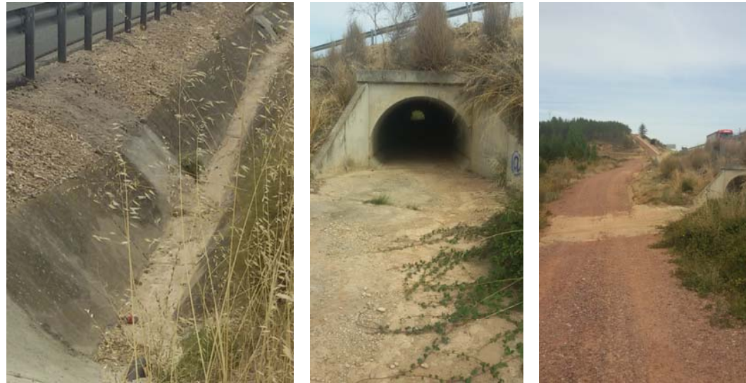
Cuneta, ODT y Camino con acumulación y sedimentación de finos erosionados y transportados por erosión hídrica (limos arcillosos beige del Mioceno Superior). Fotografías tomadas durante recorrido de campo.
