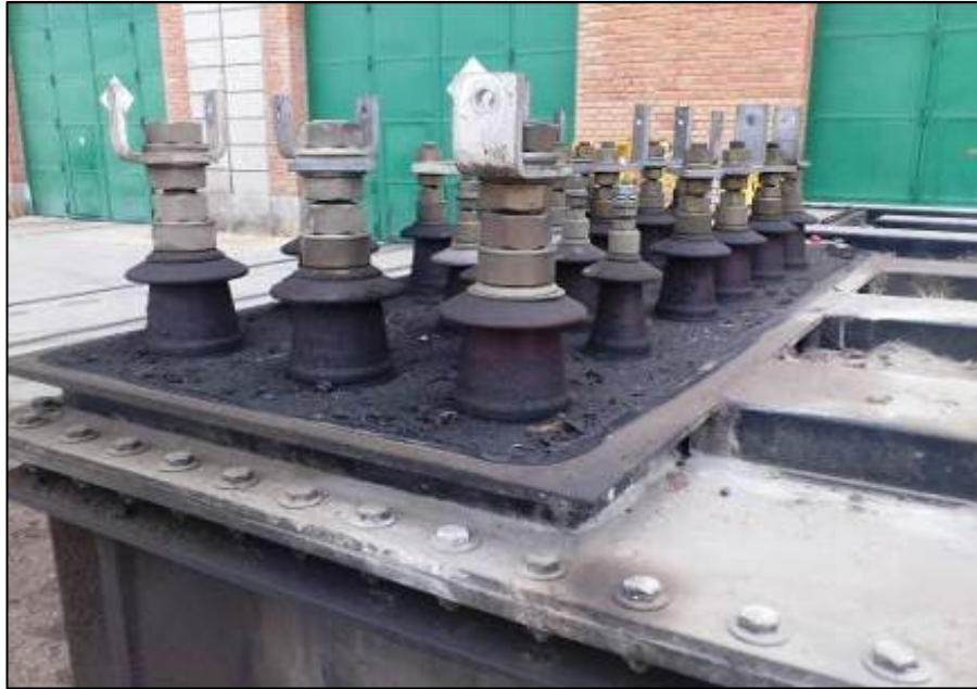
Transformador principal de una locomotora 252 en el que se aprecia la acumulación de restos de grasa y aceite en la zona de conexión. (Fuente: Renfe Operadora).
