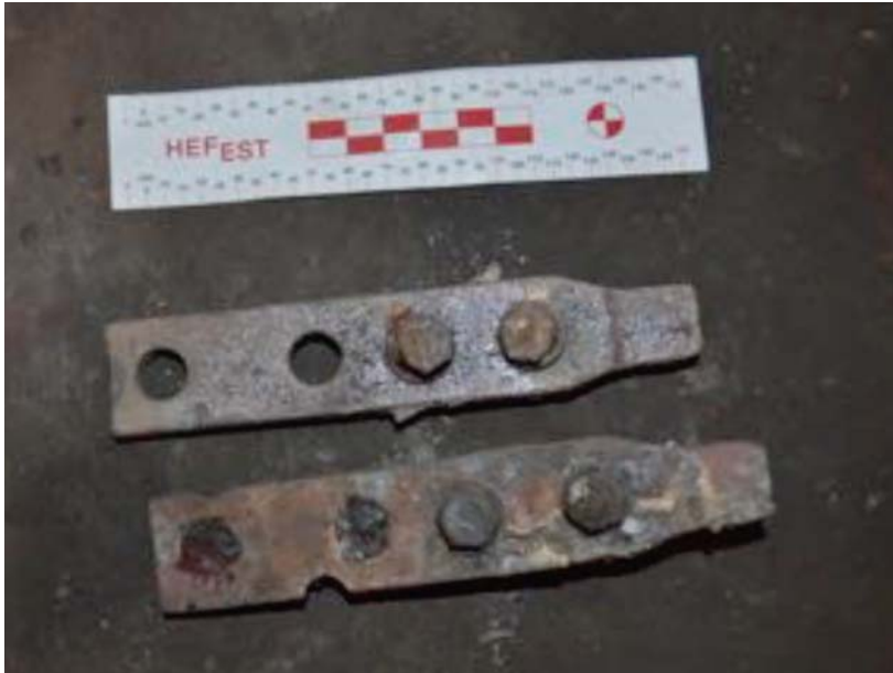
Detalle del conector del conmutador del sistema Q1. Se aprecia la afectación por fusión por causa de arcos eléctricos. (Fuente: HEFEST).
