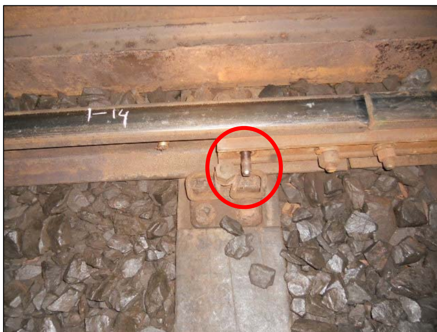
Se observa la falta de la tuerca en el tornillo de la brida. (Fuente: Renfe Operadora)
