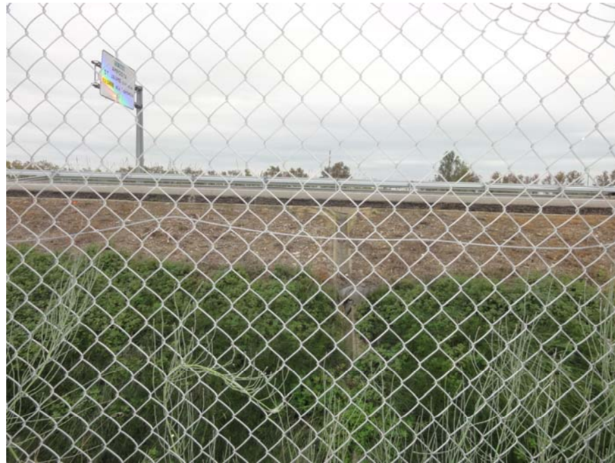
Bajante en el tronco de la N-340 en calzada izquierda.
