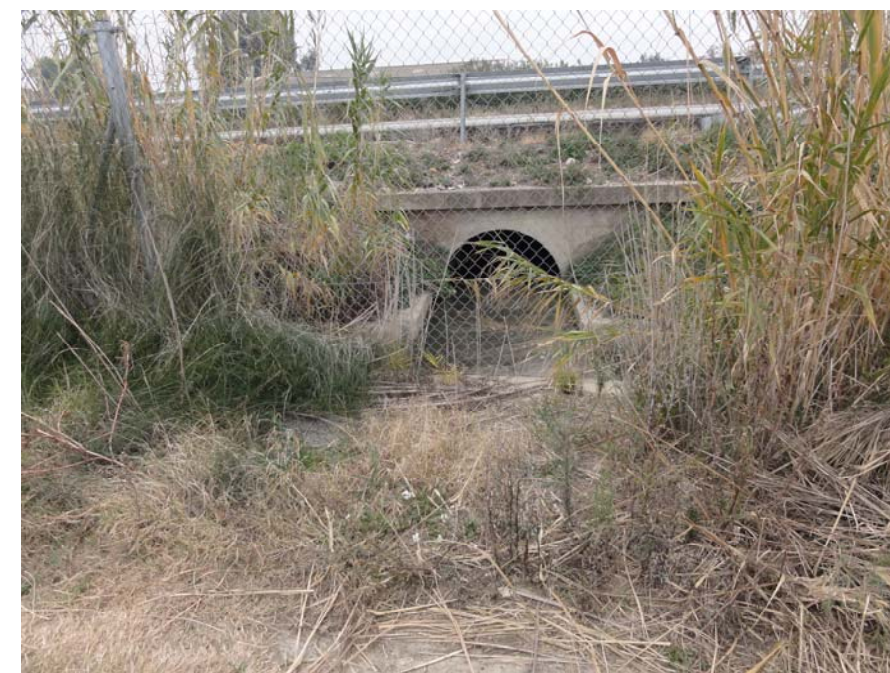
Emboquille obra de drenaje lado este, visto desde el camino de servicio.
